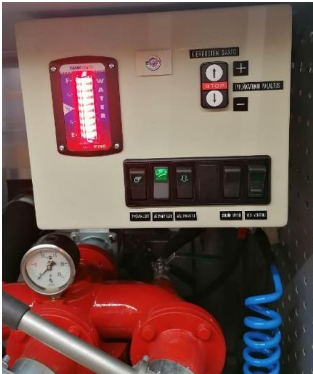
Kuva 9 Pumpun ja korirakenteen käyttöpaneeli
