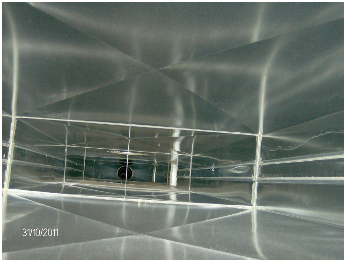
Kuva 15. Sisältä kuvatussa kantikanavassa voidaan todeta, että kanava on täysin puhdas. Tämä kuva on otettu Kaisa-talon työmaalta Helsingistä. [8]
