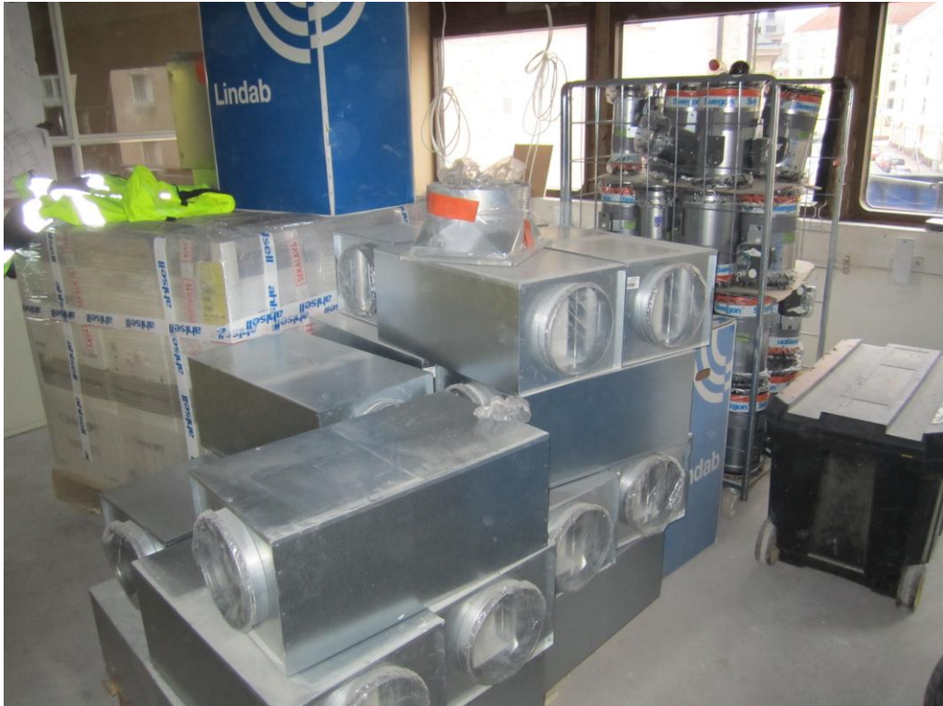
Kuva 12. Välivarastossa olevat äänenvaimentimet ja palopellit on suojattu oikeaoppisesti [9].
