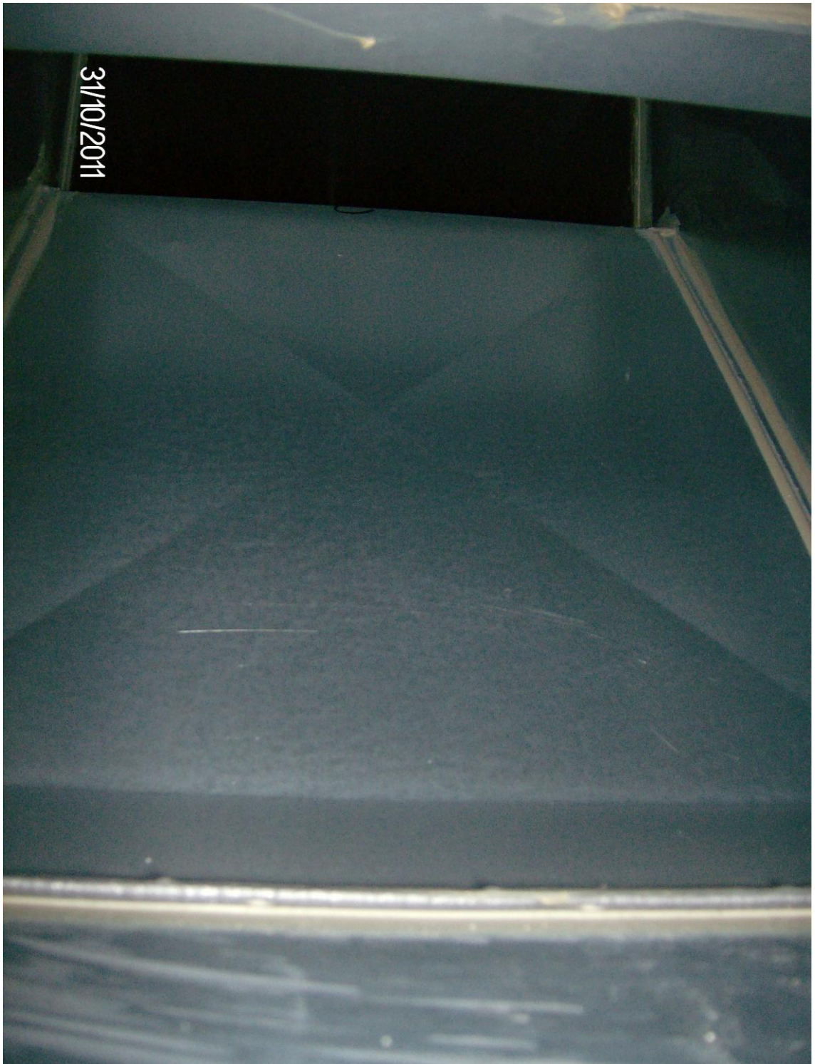
Kuva 17. Sisältä kuvattu puhdas kanttikanava, jossa saumat on kitattu ammattitaitoisesti. Tämä kuva on otettu Kaisa-talon työmaalta Helsingistä. [8]
