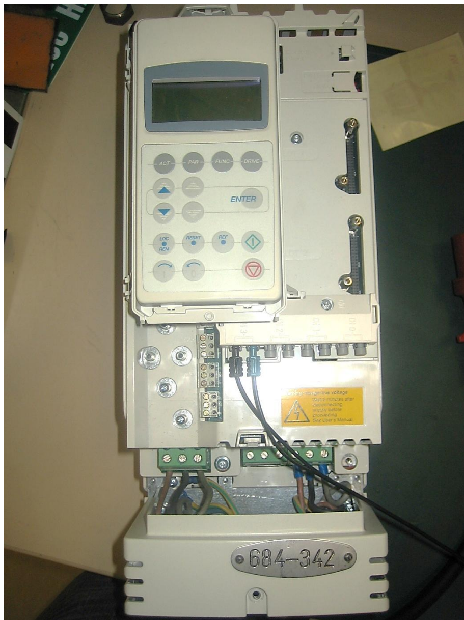
Valmis kytKentä ACS-800 taajuusmuuttajassa
