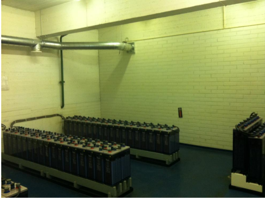
KUVA 5. Nsl2:n vasen akkuhuone, jossa sijaitsevat 2EC12 220 V:n sekä 2EF13 +26 V:n akustot.
