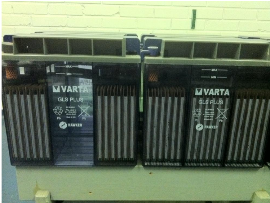
KUVA 13. Akkujen erilliskeräystä ja raskasmetallisisältöä osoittavat merkinnät.
