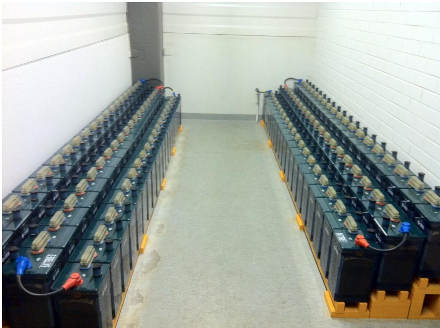
KUVA 3. Akkuhuone 1UV151T004, jossa sijaitsevat 001 ja 002 GT:n akustot
