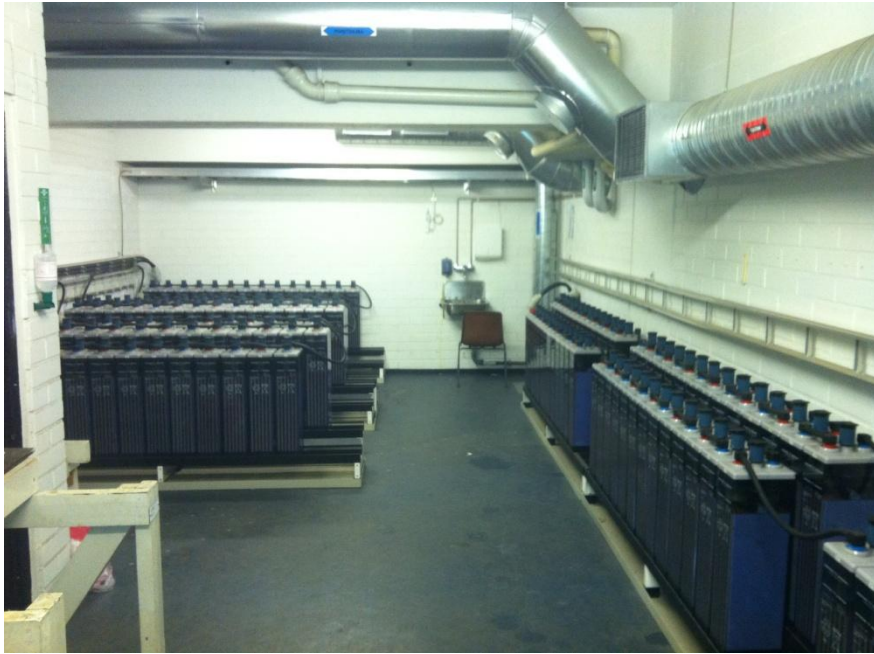
KUVA 2. Akkuhuone 1UV152T005 ja akusto 1EC25 220 V
