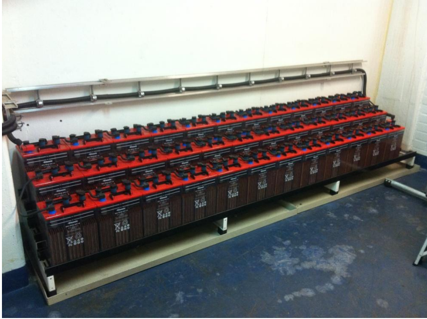
KUVA 1. Akkuhuone 1UV151T007 ja akusto 1EC035 220 V
