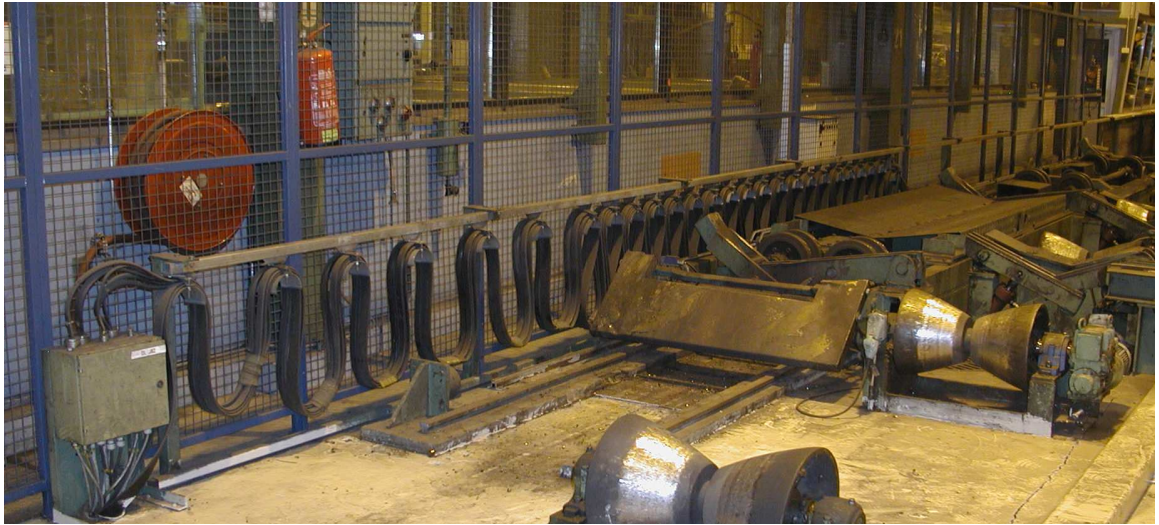
KUVIO 21. Loppupään Uä-laitteiston vaunun riippukaapelit
