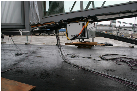
Kuva 43 400Hz asennettuna sillan alle
