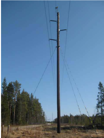
Kuva 4. Komposiittitukieristimillä rakennettu voimajohto Matkakangas-Sorosenperä 110 kV
