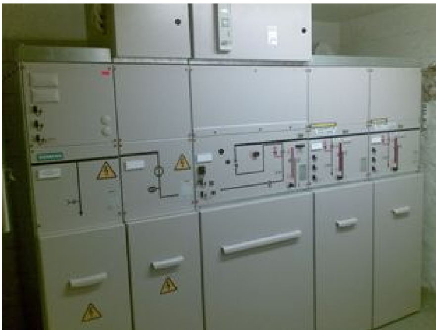
Kuva 1. Uusikatu 50 kellarin kj- kojeisto
