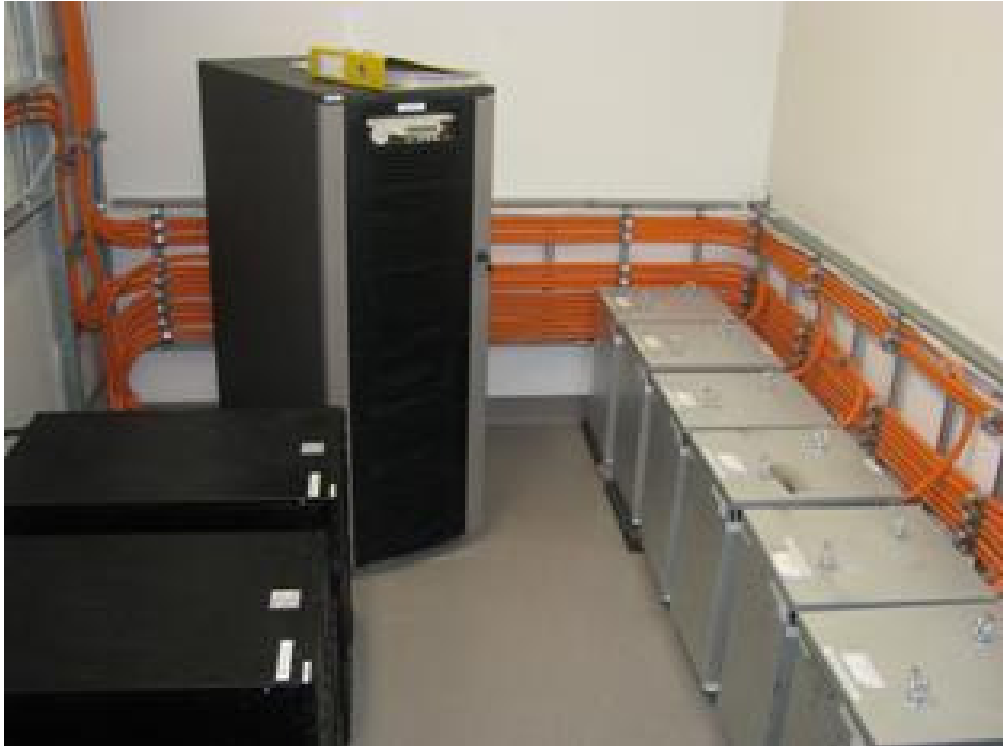
Kuva 13. UPS ja lääkitäsuojaerotusmuuntaja tila
