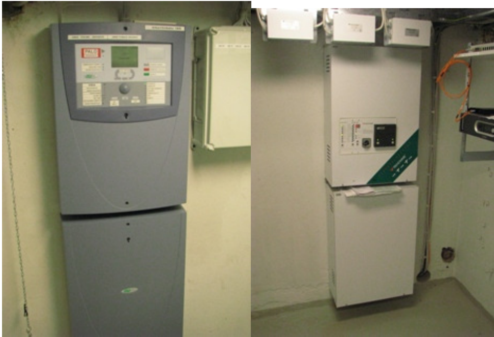
Kuva 14. Esmi FX paloilmoinnin keskus ja Teknowaren Tapsa turvalokeskus
