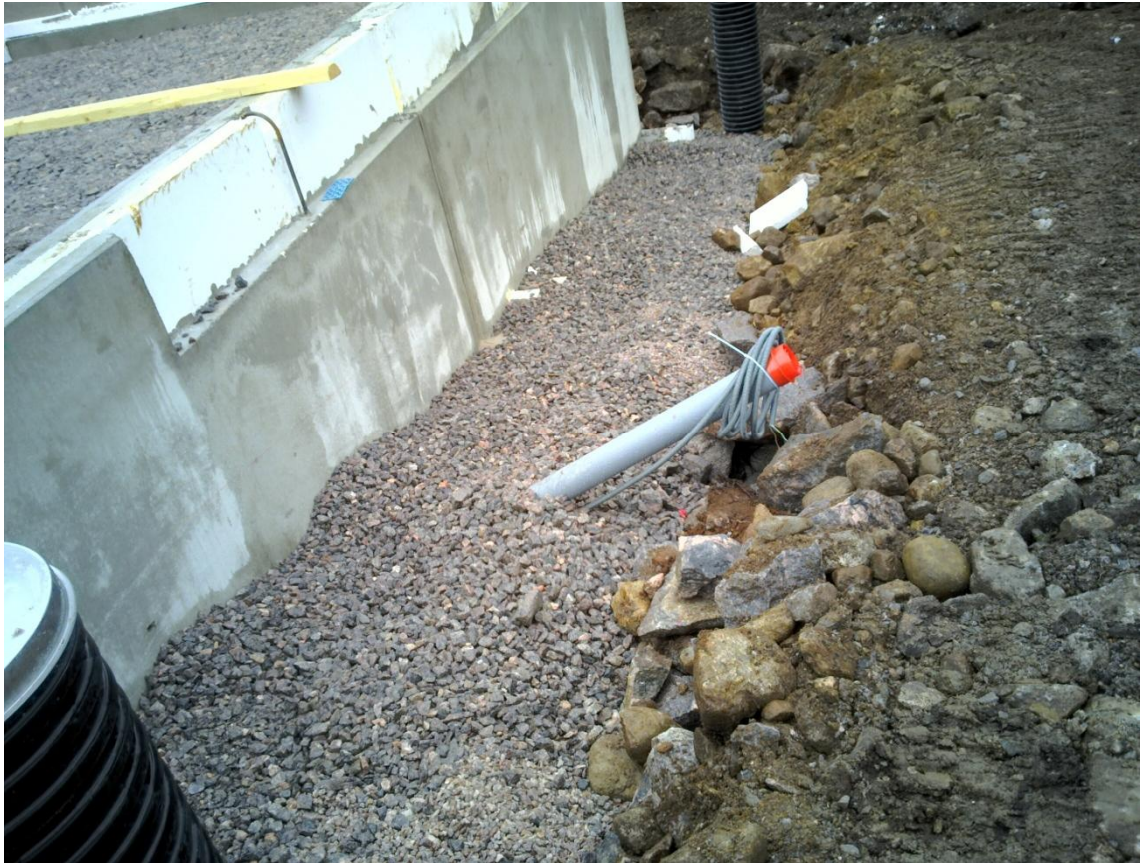
Kuva 17. Sokkelin alapuolelta tulevan runkolinjaston pää. Linjaston tämä pää tulee asennettavaksi imurille, jonne kytketään myös herätevirta, sekä rasioiden maadoitus. Putki on tuotu maasta ylöspäin 45 asteen mutkalla imuvastuksen pienentämiseksi.
