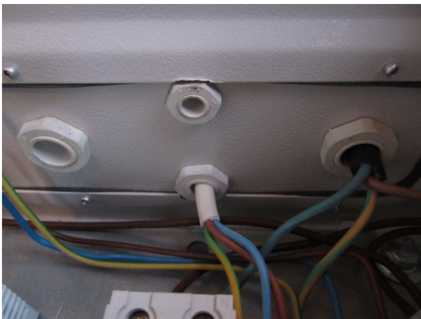
Figur 13. Kabelintag monterade i plåtflänsen.
