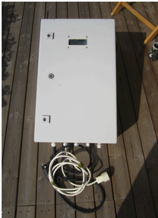
Figur 28. Det färdiga styrsystemet med dörren stängd.
