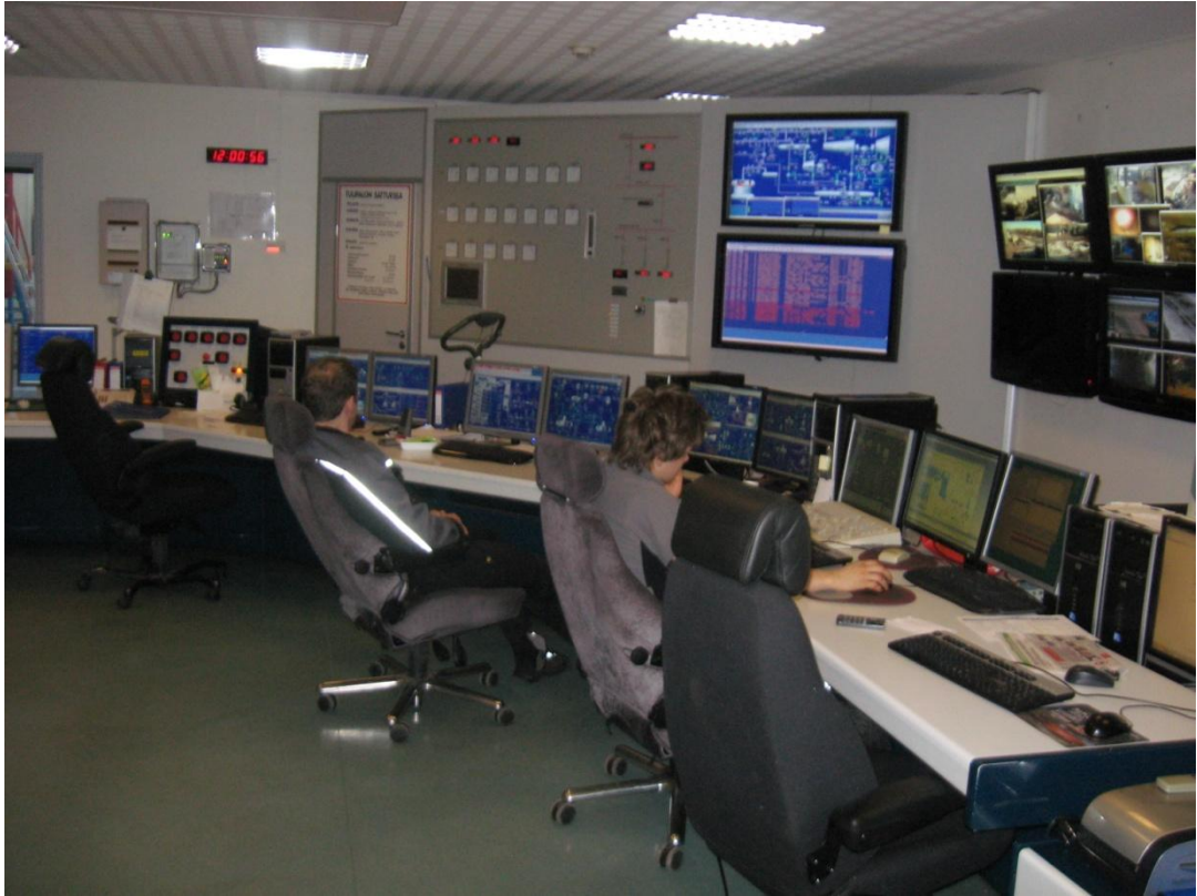
Kuva 11: Yleiskuva Hovinsaaren voimalaitoksen valvomosta ennen suurkuvanäytön hankintaa
