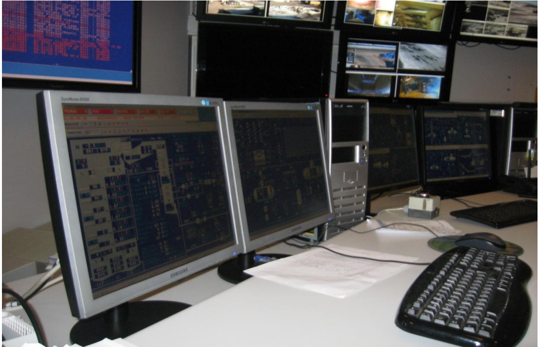
Kuva 9: Näyttökaaviokuvia Hovinsaaren voimalaitoksen valvomossa
