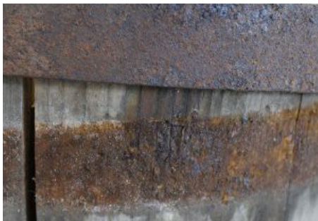
Kuva 52: Korroosion aiheuttamia vaurioita alla olevassa puupinnassa (Rajamäki 2012).
