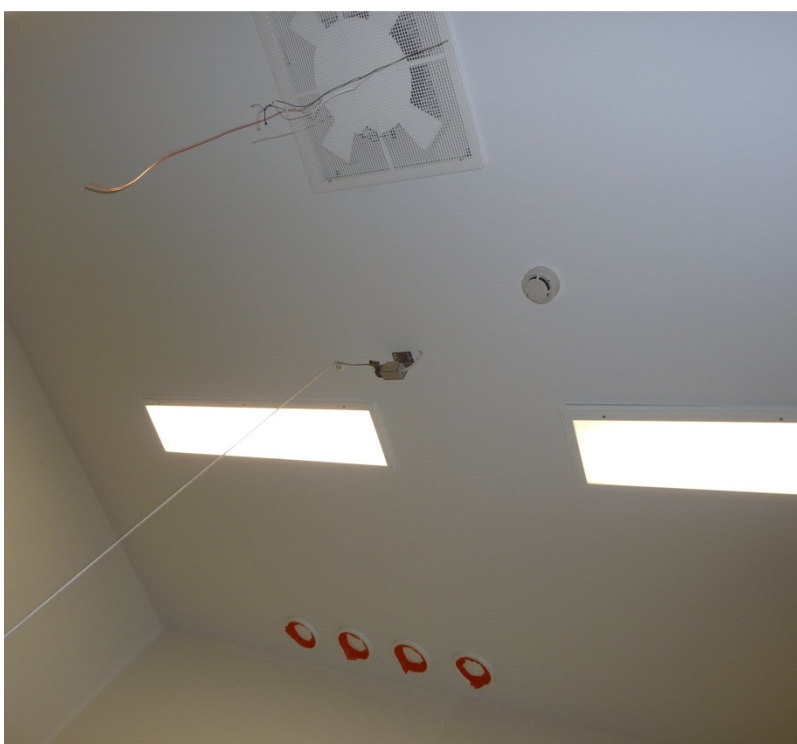
Kuva 4. Tilan 31109 tulo- ja poistoilmanpätelaitteet joista poistoilma on teipattuna.
