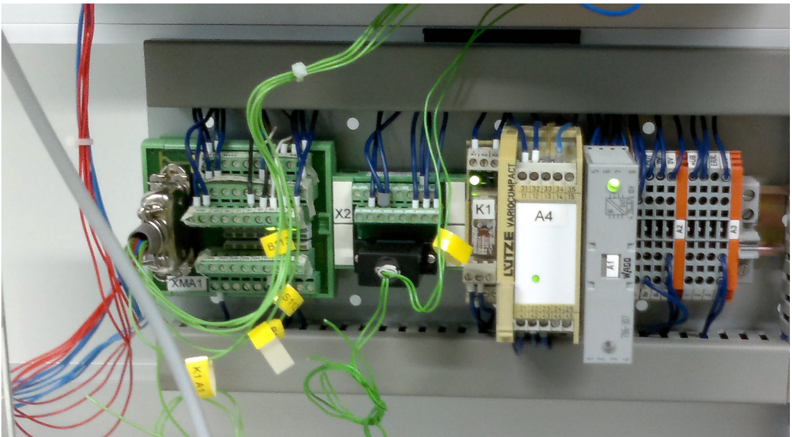
Kuva 15. Prosessin ja logiikan väliset liitântäkaapelit
