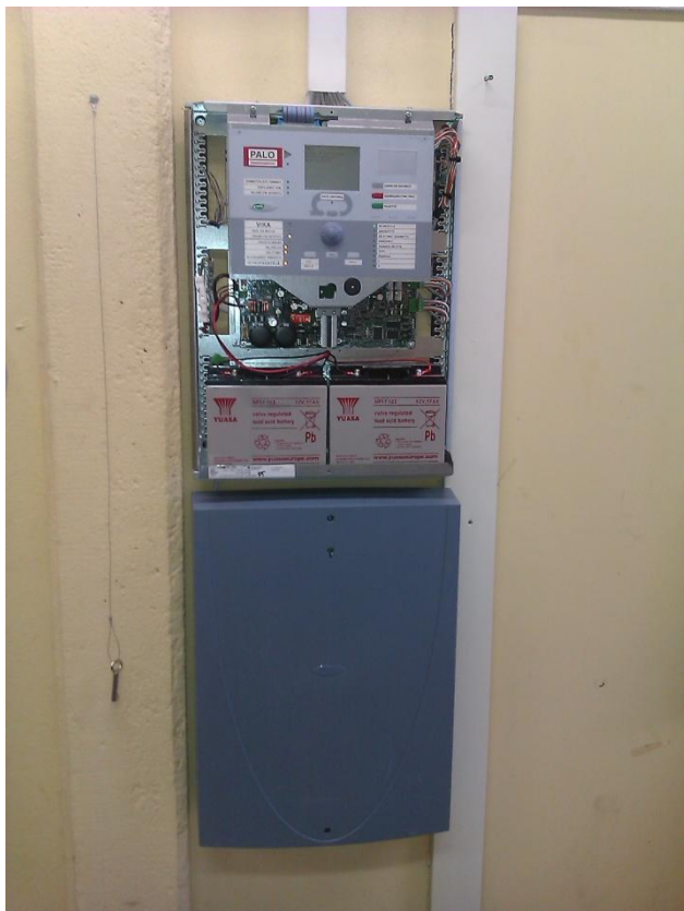
Kuva 12. Keskusyksikkö ja kaaviokotelo asennettuna.
