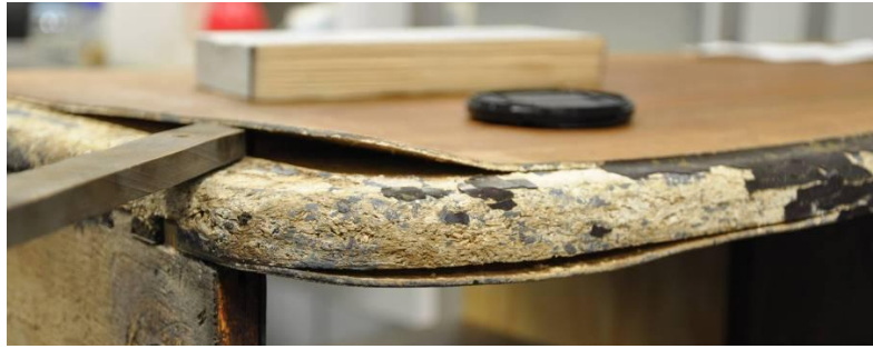
Kuva 18. Viilupinnat ja vanerit olivat monin paikoin irronneet liimauksistaan lastulevyyn. (Kangaskolkka 2012)
