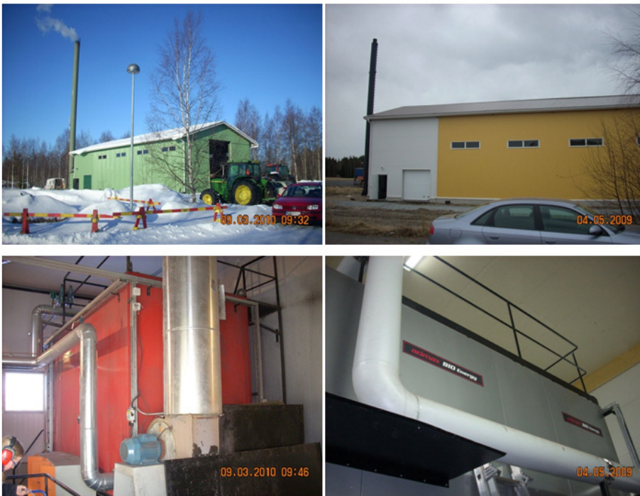
Figure 3.1. The two Kälviä 2.0 MW chip heating plants. Photos: Martti Härkönen
