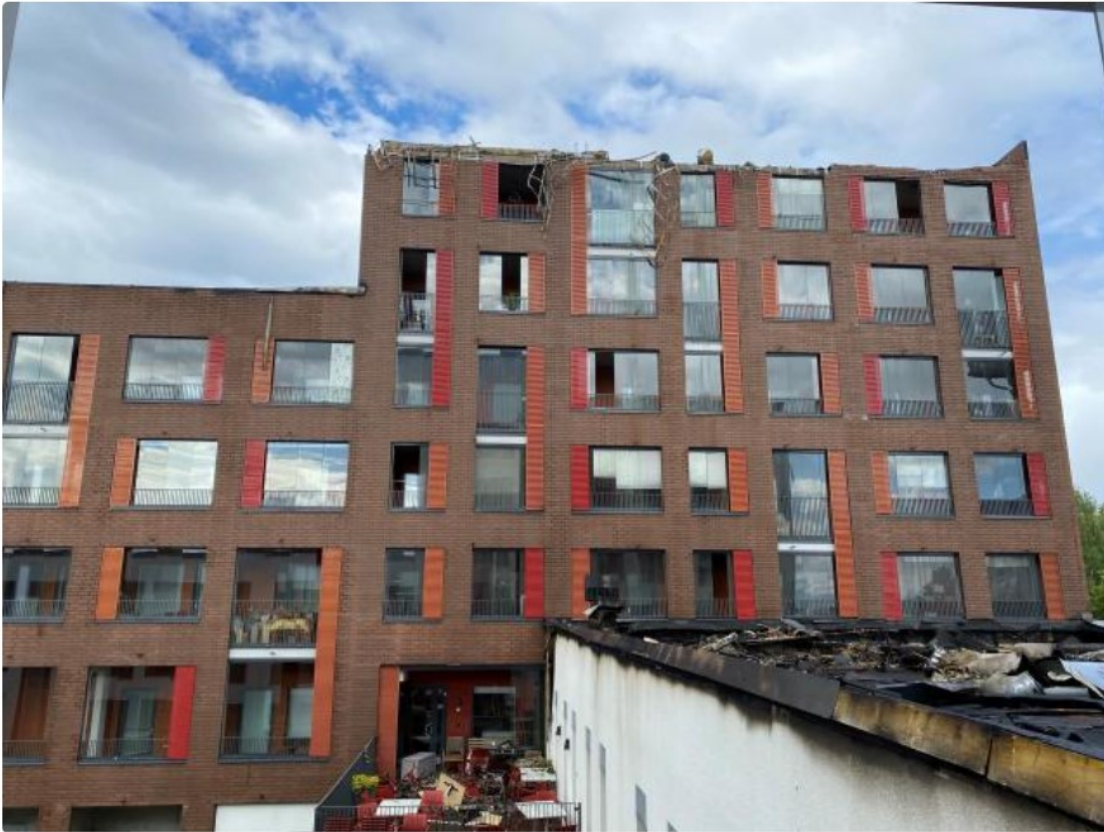
Kuva 13. Jyväskylän senioritalon tulipalo (Onnettomuustutkintakeskus 2020).
