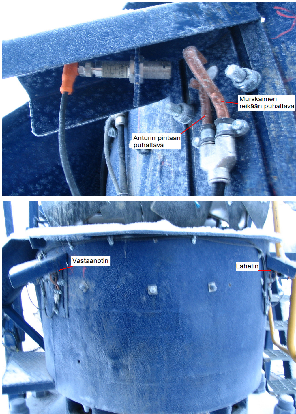
Kuva 7. Korkeusvahdit asennettuna jälkimurskaan. Asennustapa on samanlainen myös esimurskassa. Lisäksi kuvassa näkyvät antureiden puhdistusjärjestelmän suuttimet.
