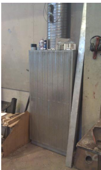
Kuva 2.2 Lattiatasossa sijaitseva piennopeustuloilmalaite. Hallissa on 6 kpl \varnothing 315 – kanavaliitoksella, 1 kpl \varnothing 400 – kanavaliitoksella ja 1 kpl \varnothing 200 - kanavaliitoksella varustettuja päätelaitteita. Näiden päätelaitteiden yhteenlaskettu tuloilmavirta on 2,5\text{m}^3 / \text{s} .
