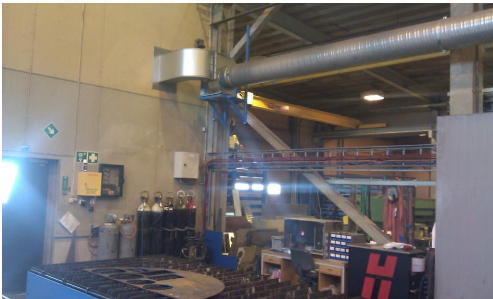
Kuva 2.15 Plasmaleikkurin poistoilmakanava, puhallin sekä seinän läpi menevä jäteilmaputki.
