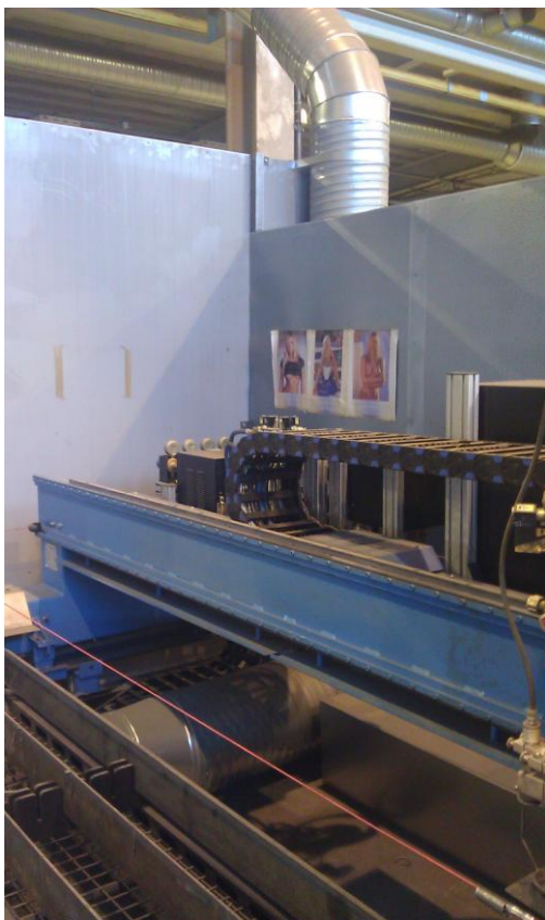
Kuva 2.14 Ilmastointipöydän alta tuleva poistoilmaputki.
