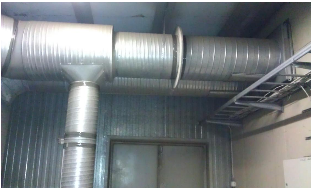
Kuva 3.20 Kahdesta poistupuolen ilmavirtasäätimestä mittaamalla paine – ero saatiin poistupuolen kokonaisilmavirta koneelle TK01.
