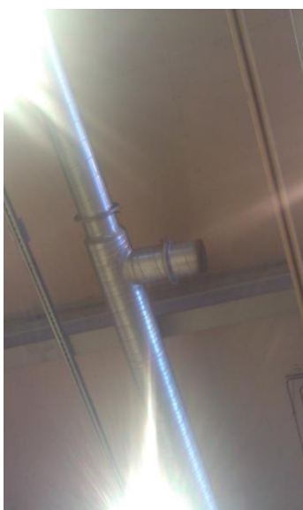
Kuva 2.4 Poistoilmakanava. Poistoilmapuolella ei ole lainkaan venttiileitä. Poistoilmapuolen säätö on tapahtunut kanavissa olevista iris – säätimistä.
