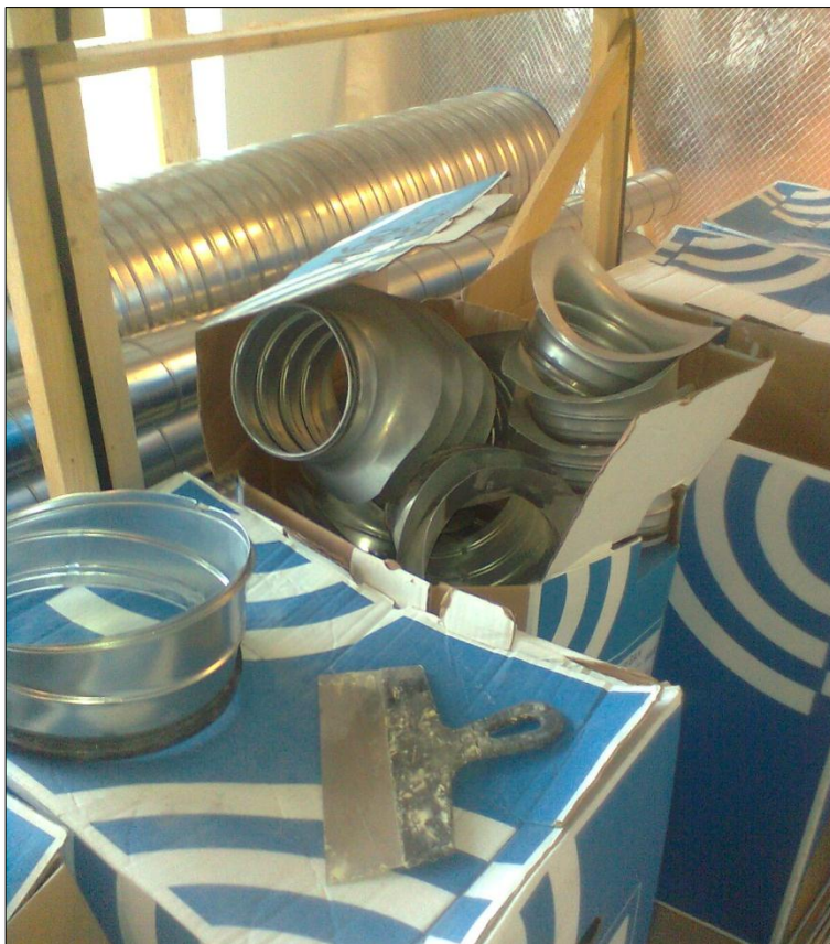
Kuva 6. P1-puhtausluokan kohteissa IV-kanavat tulee suojata, tässä niin ei ole tehty.
