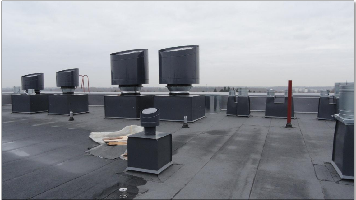
Kuva 8. Osa poistoilmakanavista vesikatolla, joiden asennus kuului lopulta IV-urakoitsijalle
