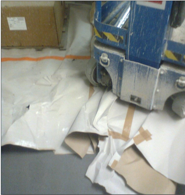
Kuva 9. Saksinostimella ajettu mattotiloihin ilman tarvittavaa suojausta.
