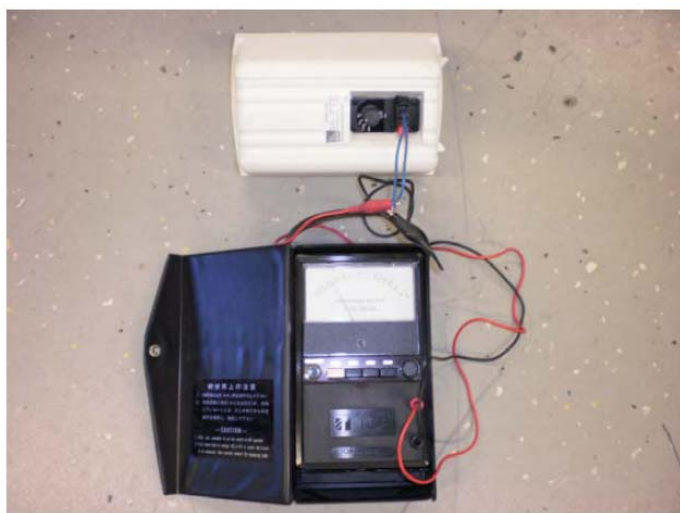
Kuva 22. Äänentoistojärjestelmän kaiutinlinjan mittaus.
