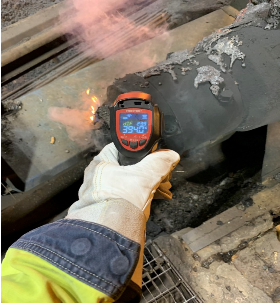
Kuva 8. Sulkutykin lämpötila nokalla sulun jälkeen 394.0° C
