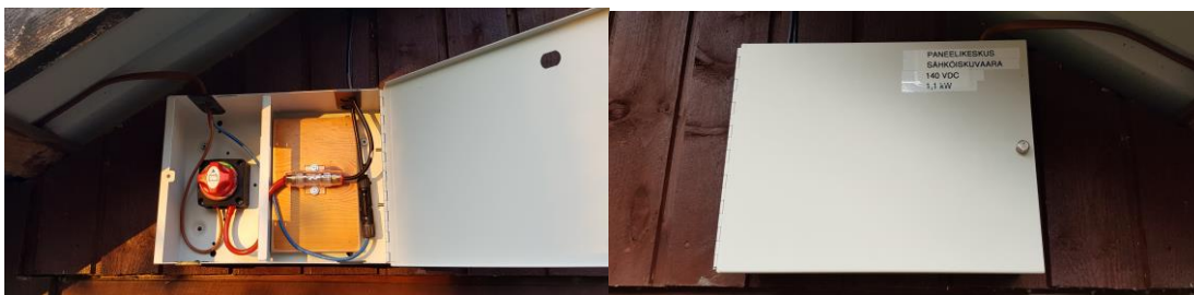
Kuva 37. Aurinkopaneelien sulakesuojus ja huoltokytkin sääsuojakotelossa.
