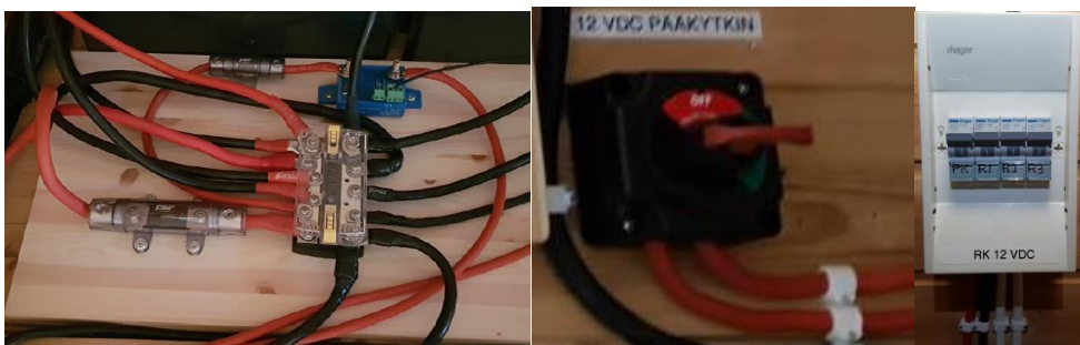
Kuva 42. Alijännitesuoja ja pääkatkaisin 12V:n ryhmäkeskuksen välillä.
