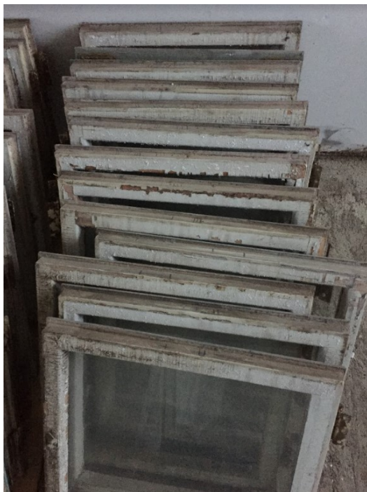
Kuva 16 Kunnostettavia ikkunoita. Kuva Juha Heino
