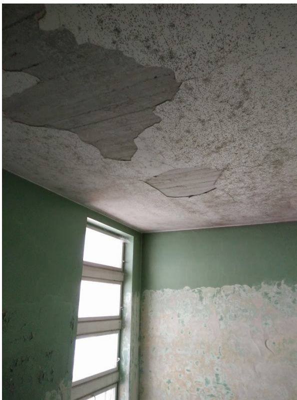
Kuva 28 Rappaukset osittain irronneet. Kuva Oliver Heino
