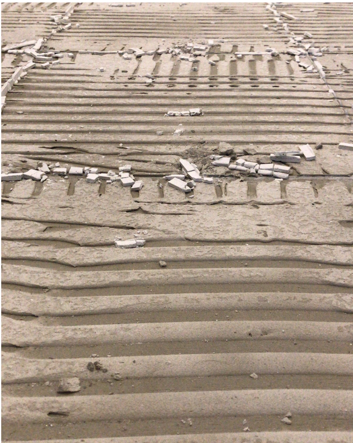
Kuva 17. Irtonaiset lattialaatat. (Vellun Remonttityöt 2018).
