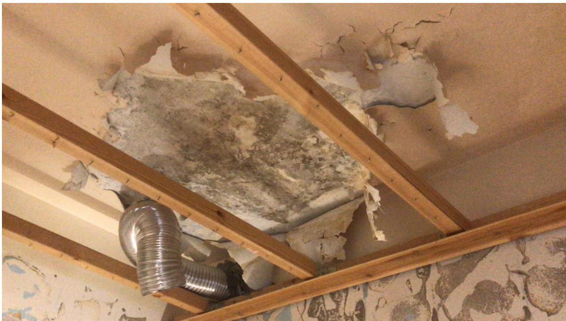
Kuva 11. Kosteusvaurio 1960-luvun kerrostalossa. (Vellun Remonttityöt 2019).
