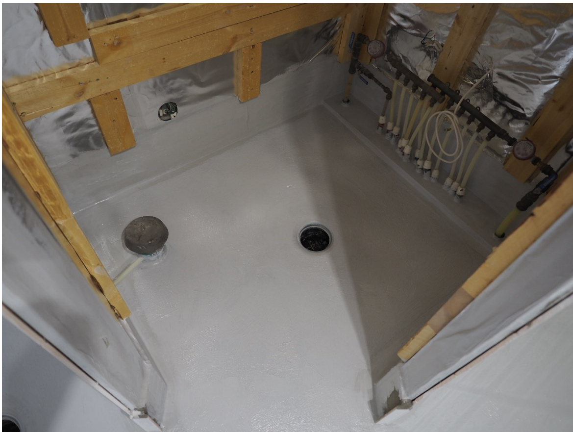
Kuva 21. Jakotukin korokevalu. (Vellun Remonttityöt 2020).
