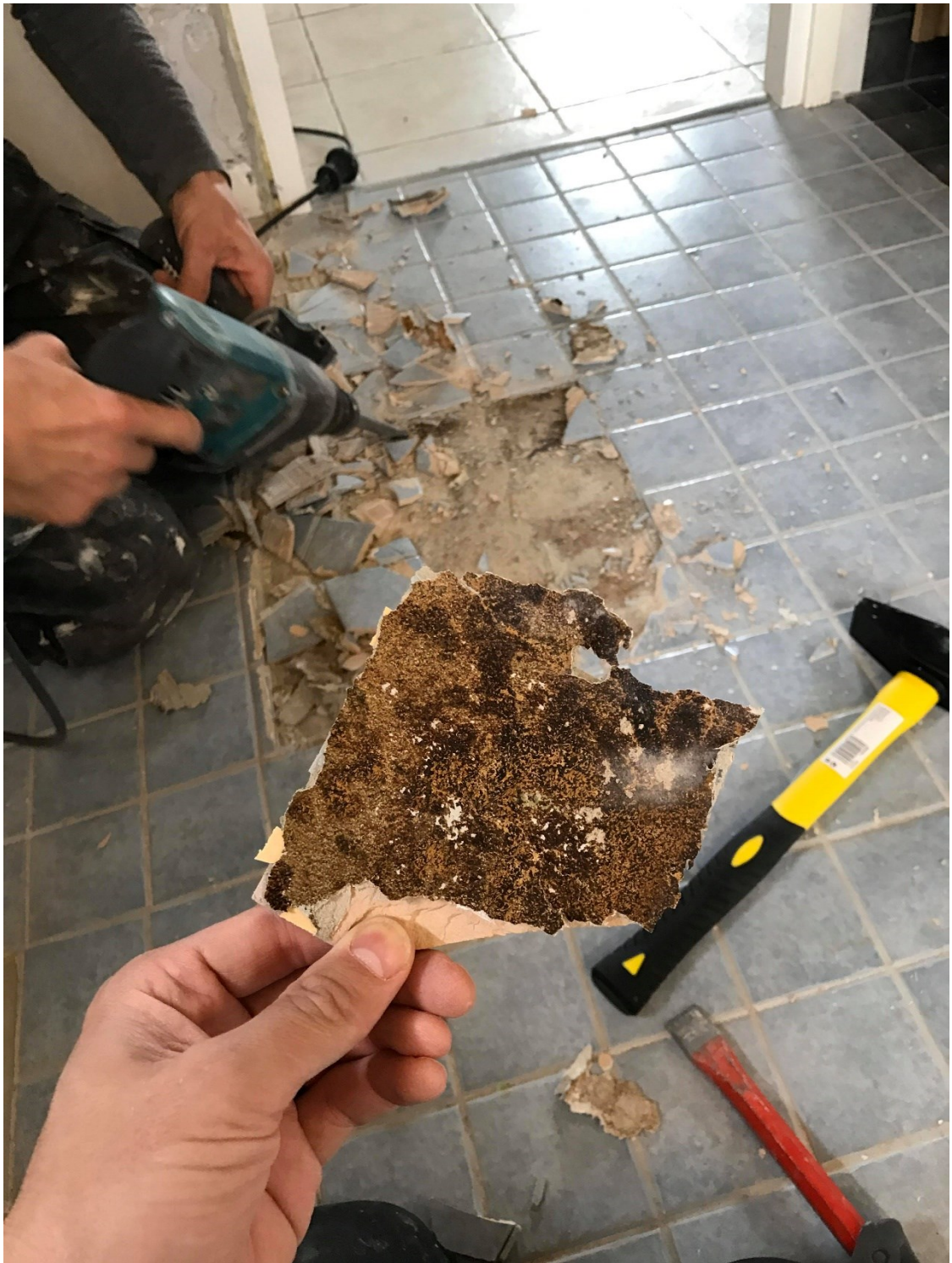
Kuva 16. Kosteutta vedeneristeen alla. (Vellun Remonttityöt 2017).
