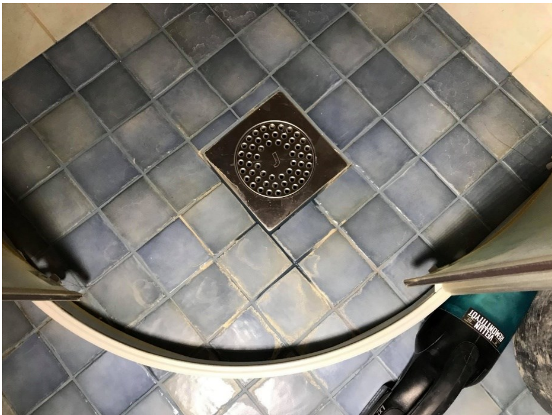
Kuva 5. Kalkkeuma 2007 vuoden kerrostaloasunnossa. (Vellun Remonttityöt 2020).
