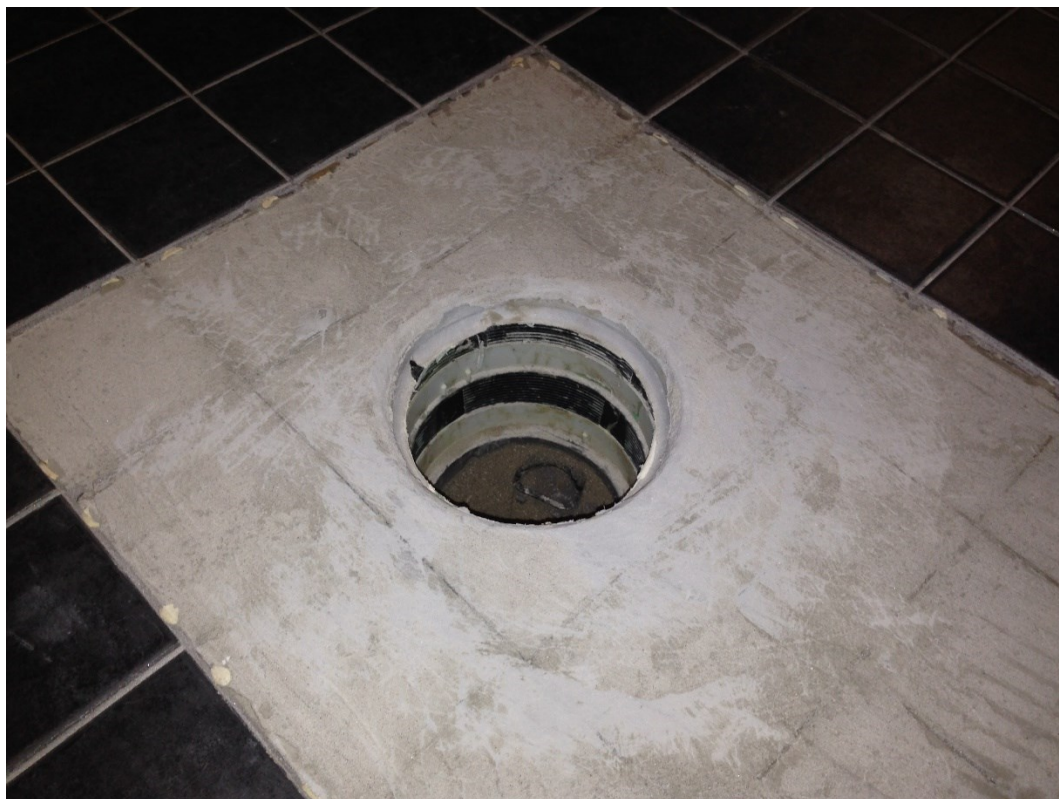
Kuva 13. Vedeneristekalvo revennyt kiristysrenkaan takaa. (Vellun Remonttityöt 2014).
