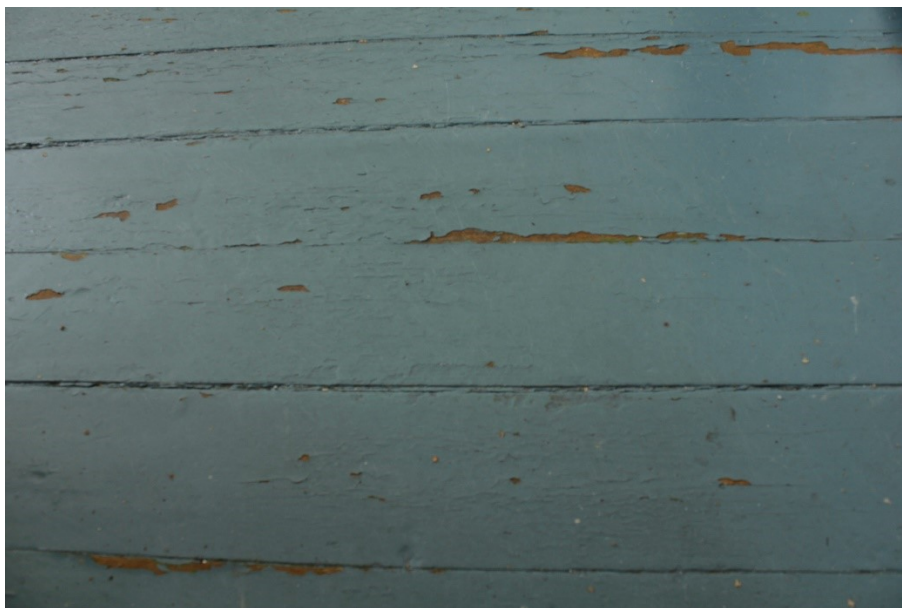
Kuva 38. Luotsikabinetin lattian maalipinnan vaurioita (Laulainen 2020)
