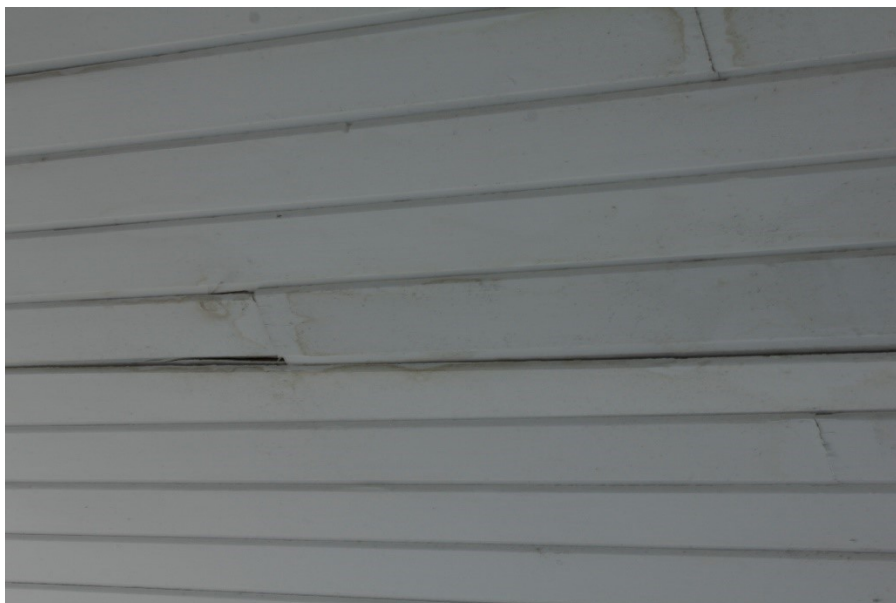
Kuva 36. Luotsikabinetin katon vaurioita (Laulainen 2020)
