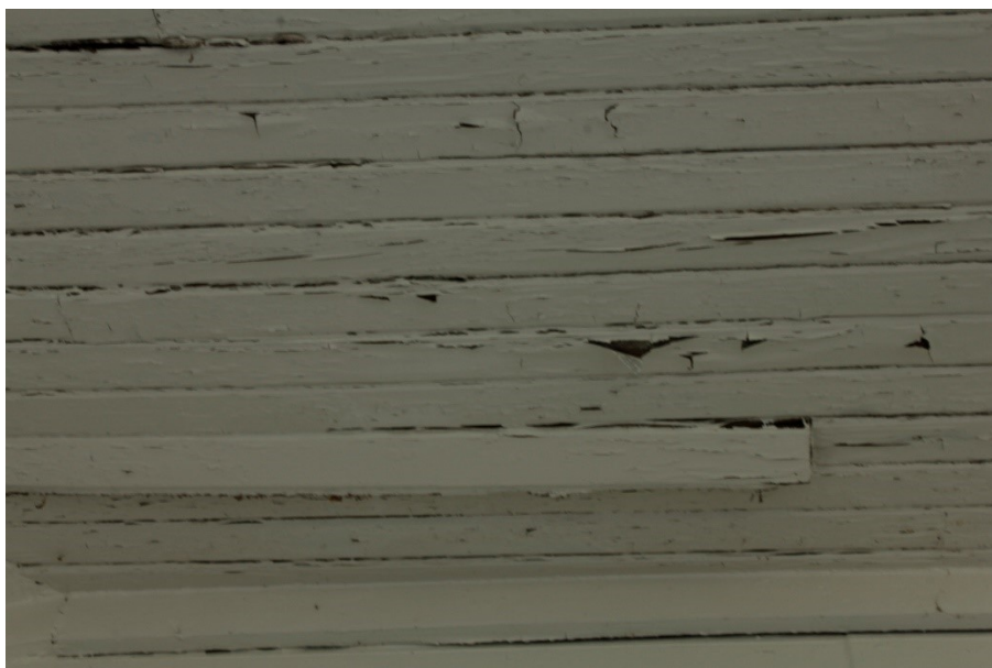
Kuva 31. Viklakabinetin katon maalivaurioita (Laulainen 2020)
