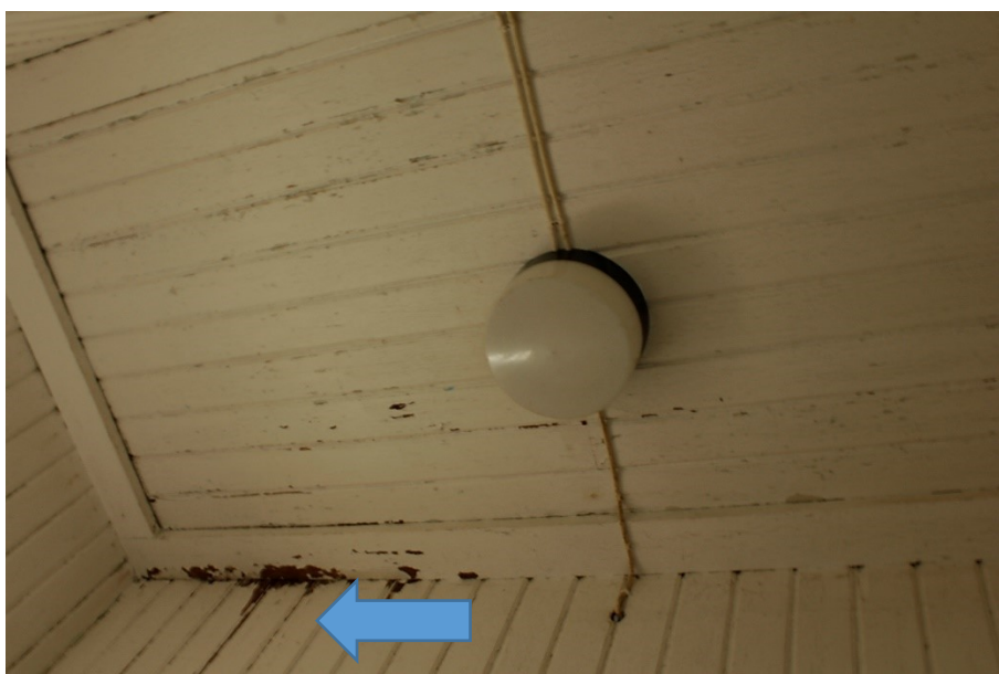
Kuva 41. Eteisen katon vaurioita (Laulainen 2020)
