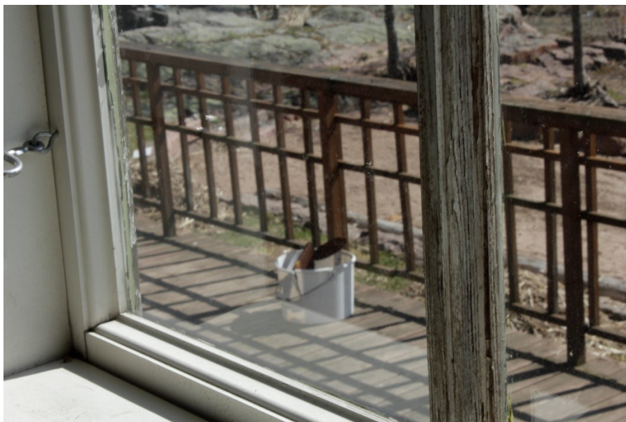
Kuva 37. Luotsikabinetin ikkunan puitteen vaurioita (Laulainen 2020)
