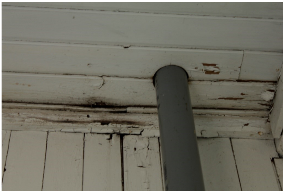
Kuva 39. WC-tilan katon vaurio kohta (Laulainen 2020)
