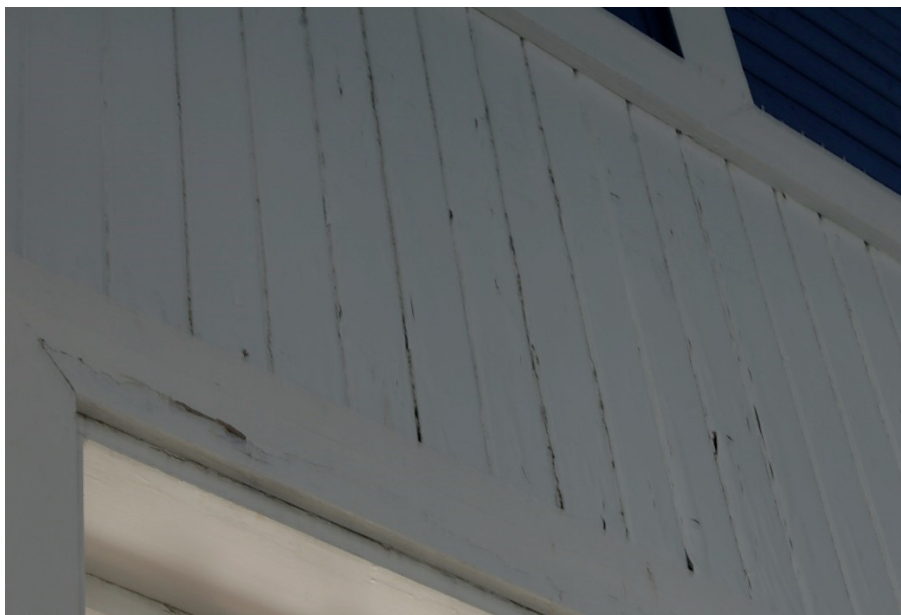
Kuva 35. Salin eteläpäädyn vauriokohta (Laulainen 2020)
