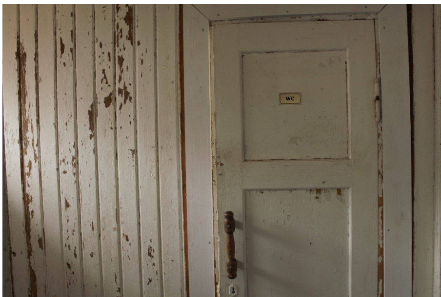
Kuva 40. Eteisen pohjoisseinän maalivaurioita (Laulainen 2019)
