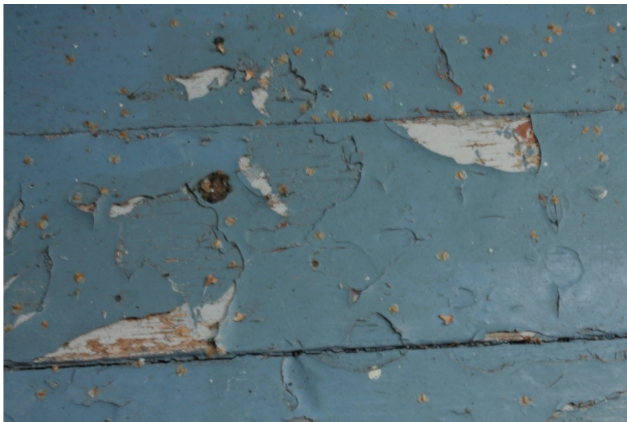
Kuva 43. Tornikabinetin lattian maalivaurioita (Laulainen 2020)
