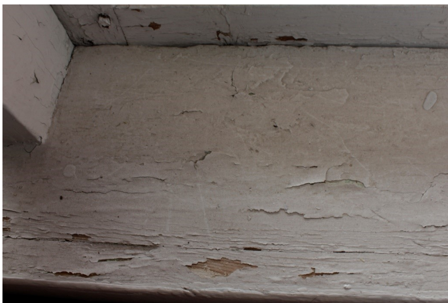
Kuva 44. Salin eteläseinän ikkunapenkin vaurioita (Laulainen 2020)
