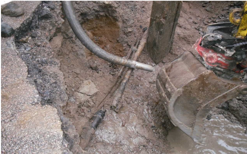
Kuva 2, havainnointikuva kaivutyön yhteydessä aiheutuneesta kaasuputken rikkoutumisesta. Auris Kaasunjakelu Oy:n arkistokuva.
