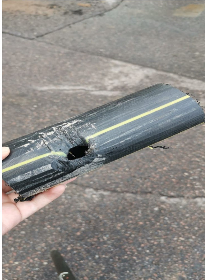
Kuva 4. Muovinen kaasuputki, johon on osuttu poraamalla. Auris Kaasunjakelu Oy:n arkistokuva.
