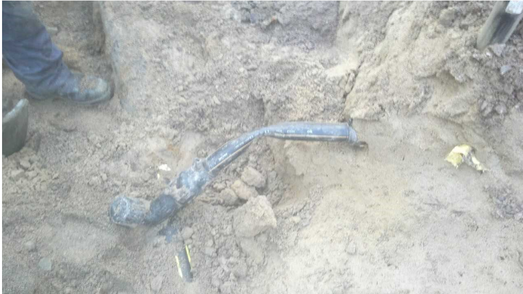
Kuva 3 havainnointi kuva muovisen kaasuputken vaurioitumisesta kaivutyön yhteydessä. Auris Kaasunjakelu Oy:n arkistokuva.
