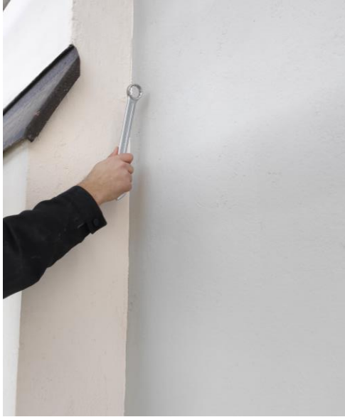
Kuva 5. Kopokartoitus on hyvä tehdä laajemmalle alueella, vaikka vaurioitunut alue tiedetään. Vertailevilla tutkimuksilla saadaan käsitys vaurioiden kehittymisestä. Kuvassa muurattu pilarimainen julkisivun koriste, joka on mahdollisesti muurattu tiilestä.
