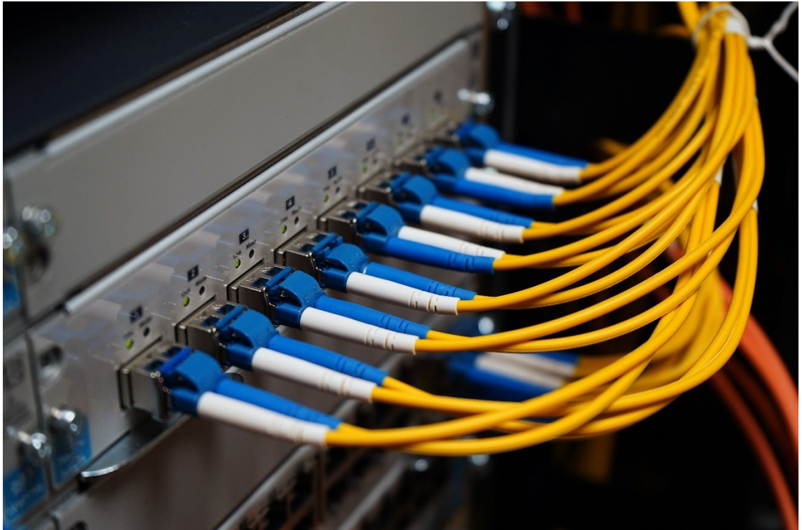
Kuva 8. Valokuituja kytkettynä verkkolaitteeseen. [17]
