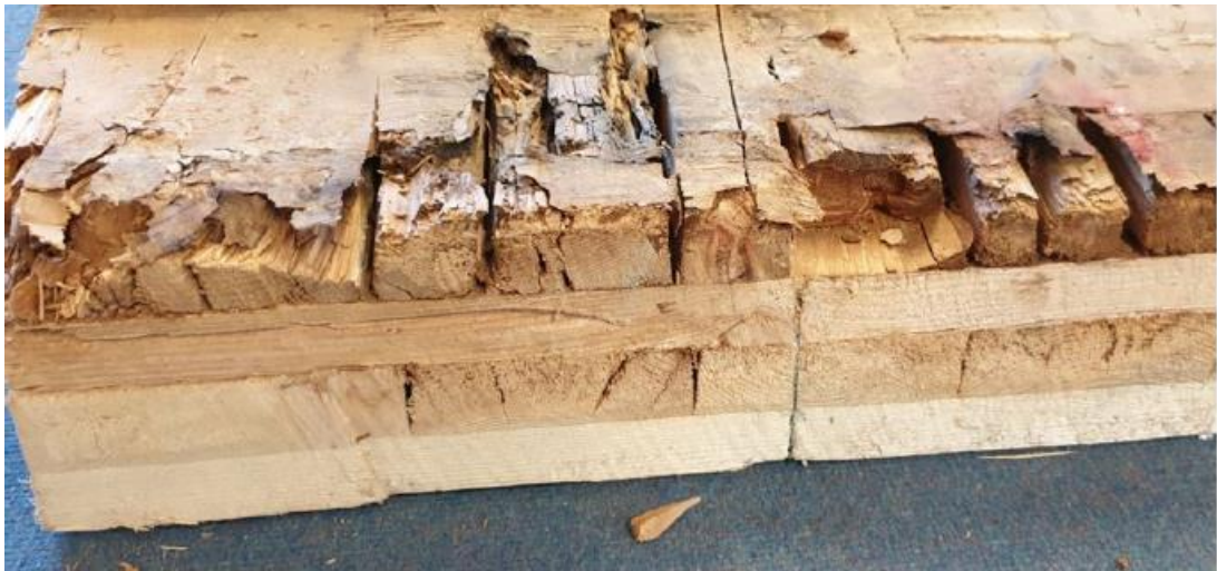
KUVA 4. Kosteuden vaurioittama CLT-levy (Structural-Safety 2019).
