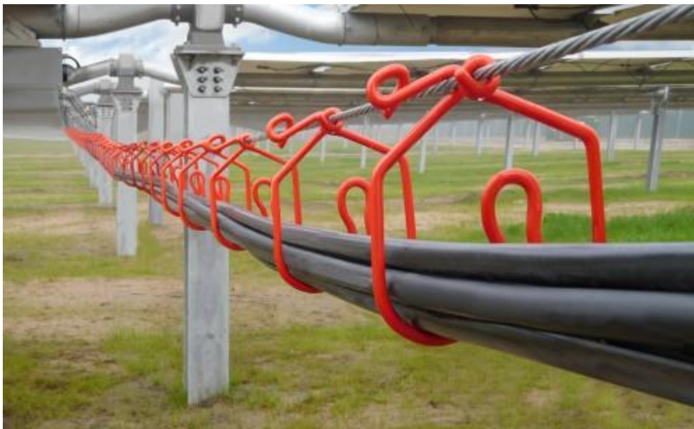
Kuva 3 Maanpäälliset AC-kaapeloinnin kannakkeet
