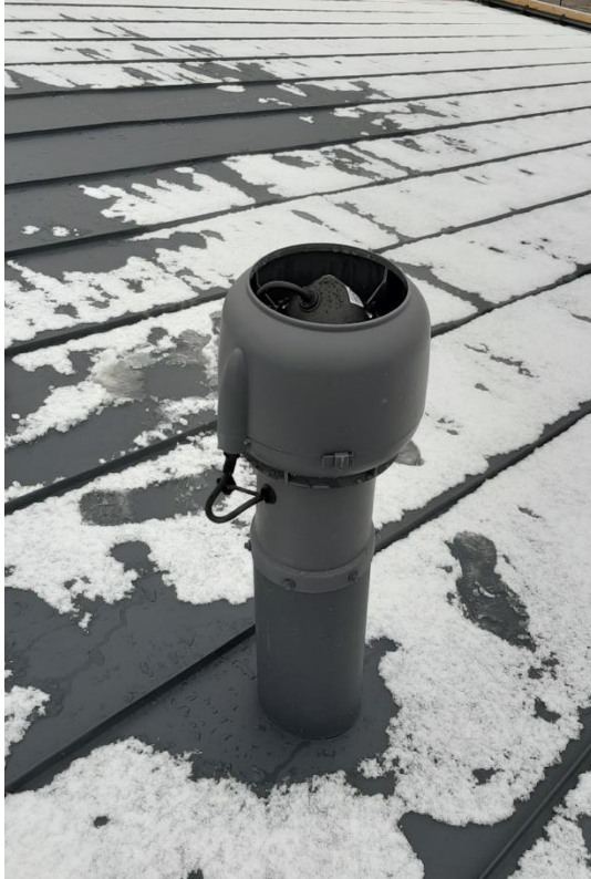
Kuva 18. Huippuimuri esimerkkikohteen vesikatolla
