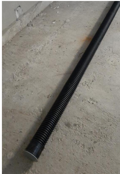
Kuva 16. Tuuletusputken tulpattu pää
