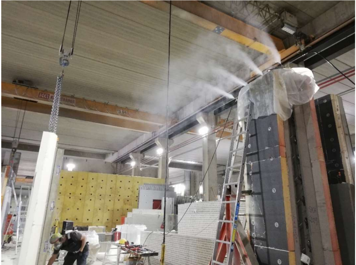
Kuva 6. Vesisumutuslaite käytössä viimeistelypäässä
