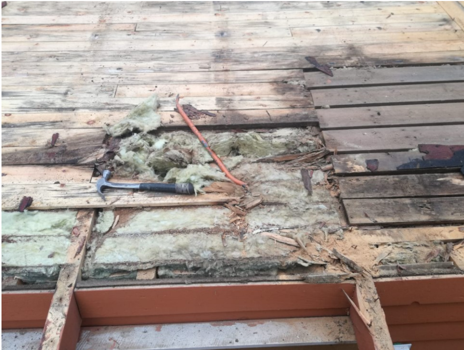
KUVA 1. Ruodelaudoituksen ja lämpöeristeen välissä ei ollut tuuletusrakoa, eristeet olivat kiinni ruoteiden alapohjassa noin kolmen metrin matkalla räystäältä harjalle päin. Oikeassa laidassa havaittavissa vanhaa jo aiemmin korjattua rakennetta.
