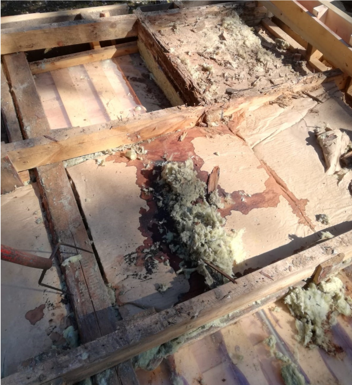
KUVA 3. Kuvassa havaittavissa lahonneita kattorakenteita ja vaurioitunutta eristettä. Osa vaurioista tuholaisien aiheuttamia. Vasemmassa laidassa näkyy katon tukirakenteena toiminut 5":n parru.
