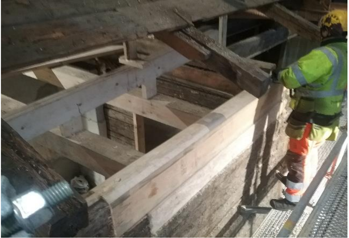
Kuva 27. itäsivu, tämä kuva on otettu samasta kohtaa kuin edellinenkin, siinä nähdään hyvin YP:n korjauksia ja ulkoseinän korjauksia, kattotuolien päiden korjaukset meneillään, 15.1.2018 (Kaikkonen)
