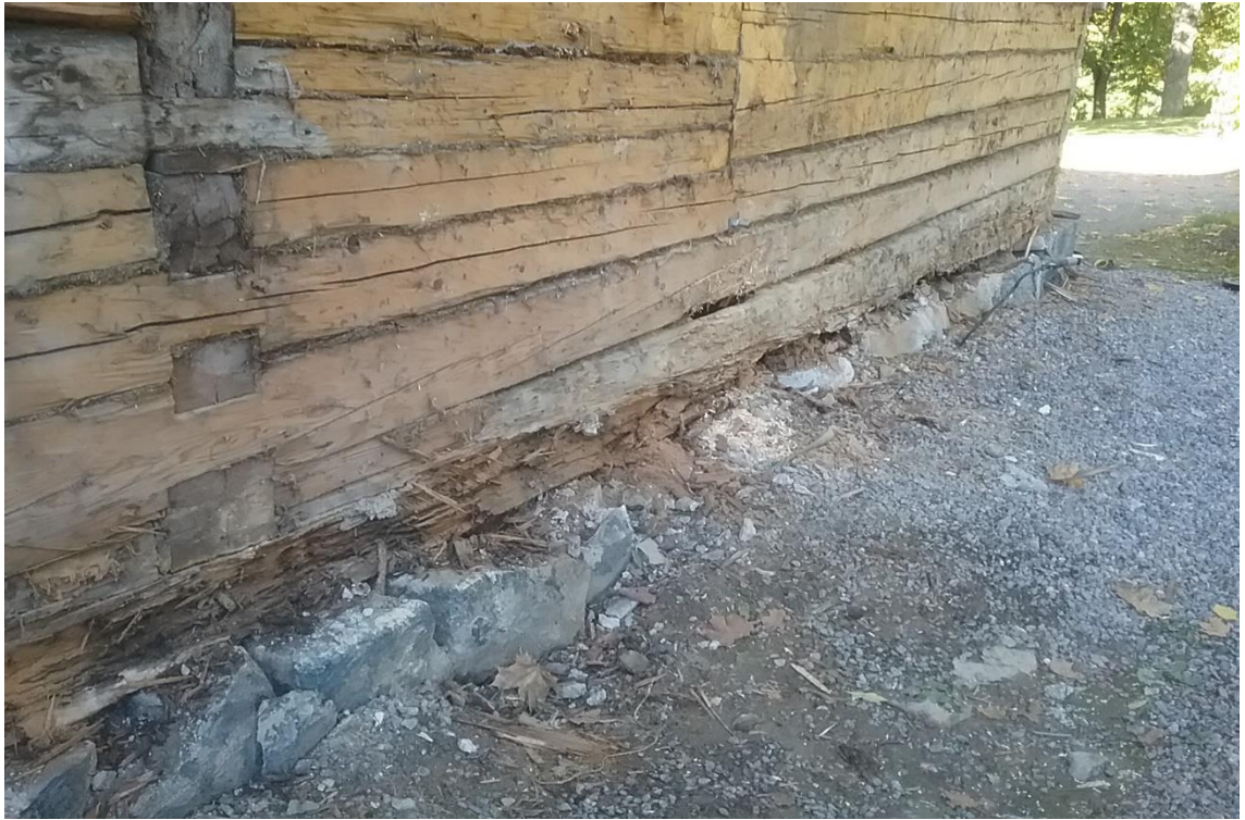
Kuva 9. Alahirsien kosteusvaurioita ennen itäsivun kengityksen aloittamista, 25.9.2017 (Kaikkonen)
