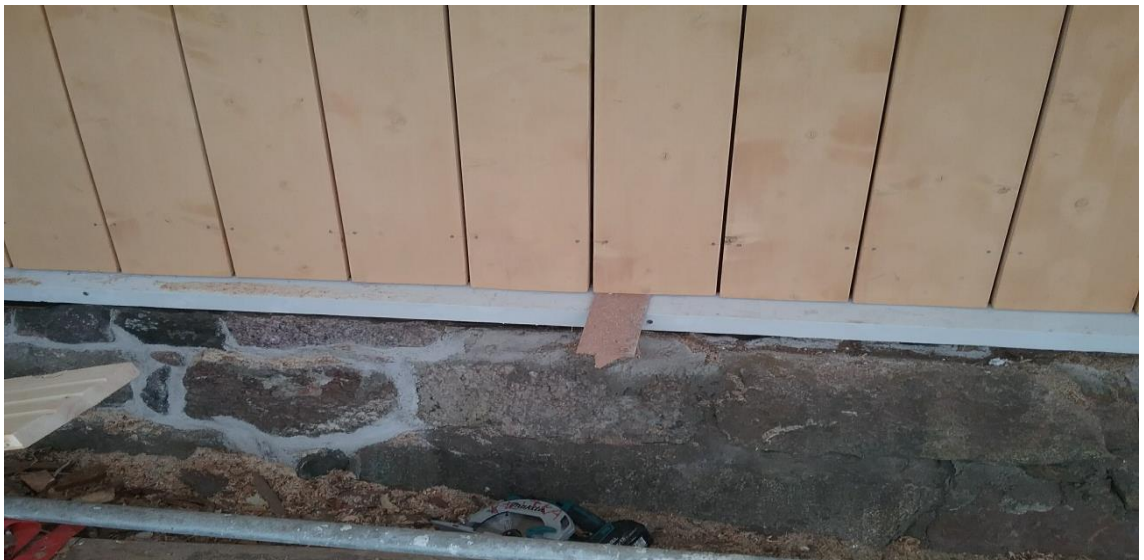
Kuva 37. Asennusväli nähtävillä, elämisvara. Alalistan ja laudan väliin jätettiin pieni rako kuivumisen parantamiseksi. Ulkoseinän toteutettiin malliasennus, lauta 28 mm, rima 30 mm ja alimmaisena päältä vinoon sahattu ja maalattu rima. 8.2.2018 (Kaikkonen)
