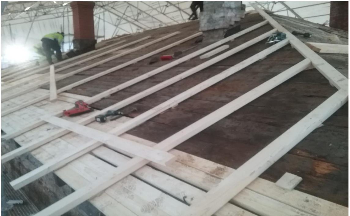
Kuva 31. Itälape, katon tuuletusvälit, 50x 100 piirulla, alle lautakorjaukset katto-tuolikorjausten päälle. Kattotutkan urakka alkanut toden teolla, 25.1.2018 (Kaikko-nen)
