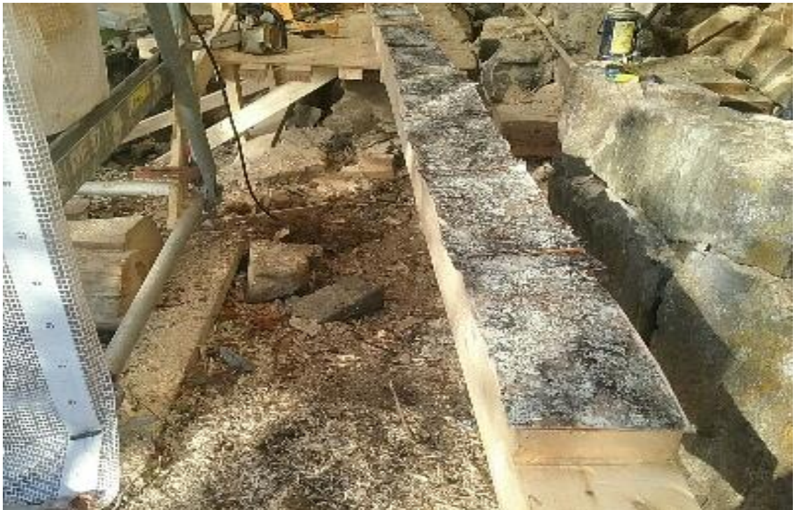
Kuva 16. Länsi, ensimmäinen uusi hirsi tulossa paikalleen. Käytössä perinteiset työtavat, joten alimman hirren alle asennetaan koivun tuohi kosteuseristeeksi, 20.10.2017 (Kaikkonen)
