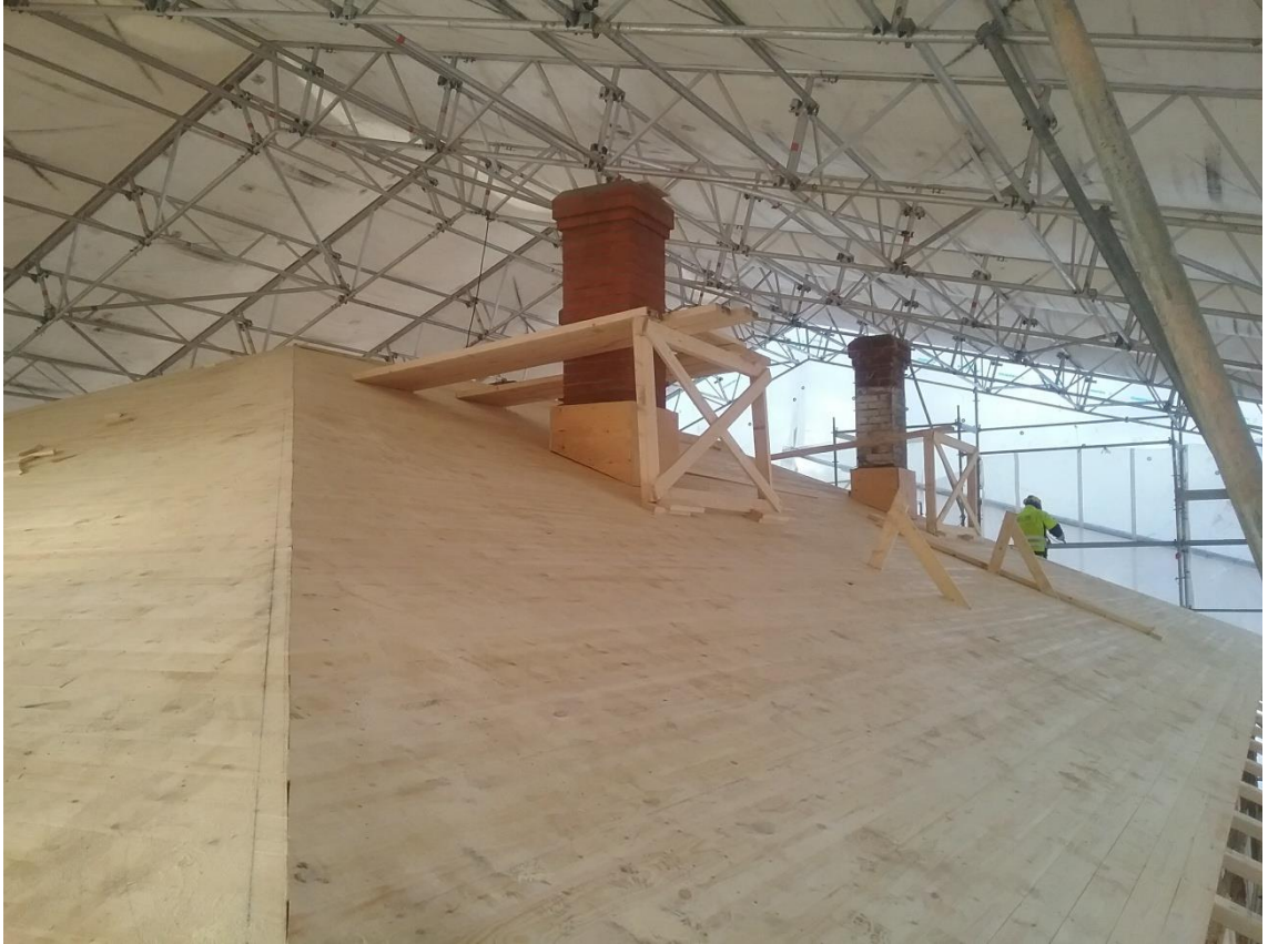
Kuva 32. Kattotyön ponttilaidoitus valmiina, katto huopaa vailla. Piippujen korjausmuuraukset tehty, telineiden purku meneillään, 31.1.2018 (Kaikkonen)
