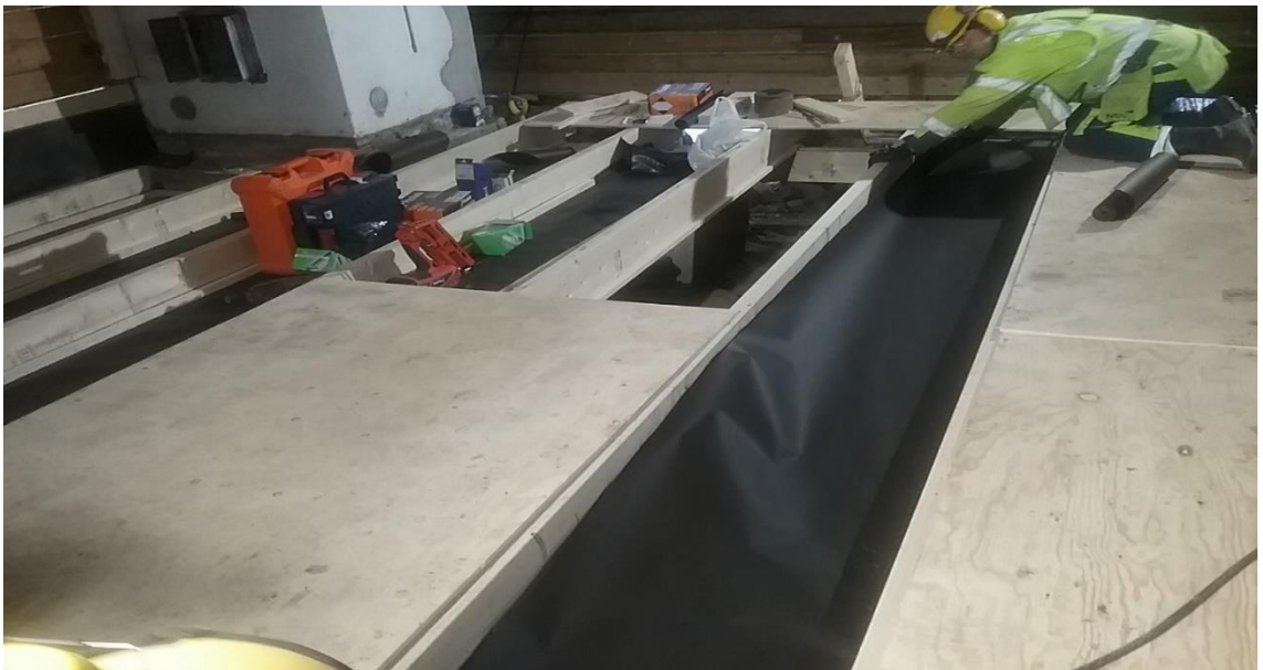
Kuva 42. Kattotyön ja osin hirsityön kanssa samaan aikaan aloitettiin lattioiden tekoa. Ne toteutettiin kokonaan uudella rakenteella, vanhat jouduimme aiemmin purkamaan mikrobivaurioiden vuoksi. Toteutustapana käytimme vanhaa perinteistä lattiarakennustapaa. Pintaan tuli leveä lattialankku, kanteen tilaan vanhat, muihin uudet ja ne lopuksi maalattiin samalla sävyllä yhtenäiseksi, 1.12.2017 (Kaikkonen)
