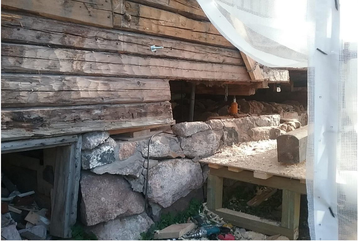
Kuva 13. Itäsivu odottaa vuoroaan, siirryttiin länsipuolen pitkälle sivulle, tässä purkuvaiheet meneillään. Näkyvillä myös kiviperustuksen kunto, joka korjattiin tämän jälkeen, 19.10.2017 (Kaikkonen)
