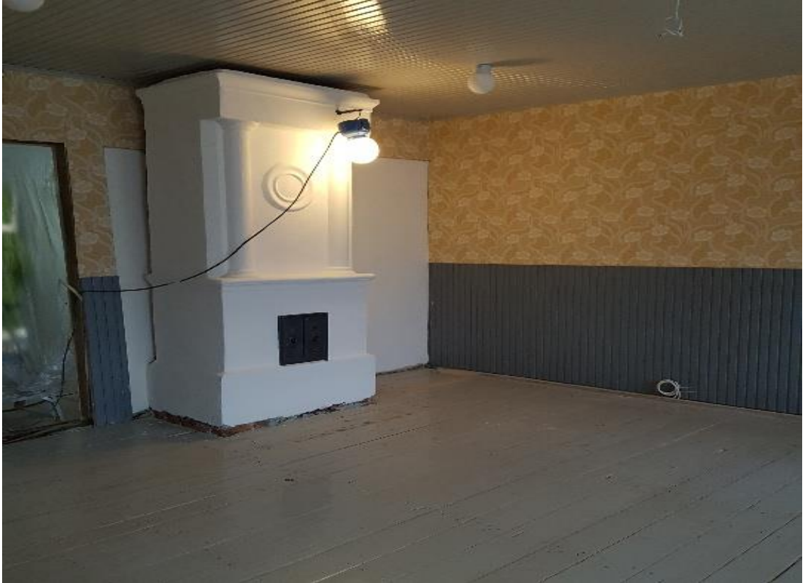
Kuva 45. Huone 111 Sali, lattiassa vanhat lankut maalattuna ja seinä tapetoitu, uuni ja muuri pinnoitettu kalkkimaalilla odottaa listoituksia ja oviaasennuksia. Katon panelointi suoritettu ja katto maalattu, 24.4.2018 (Kaikkonen)
