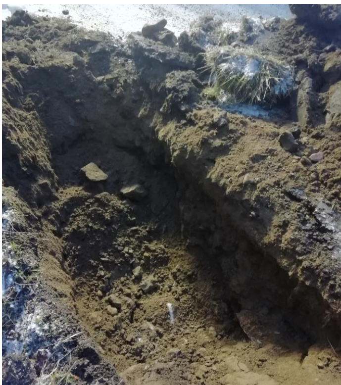
KUVA 11. Kadun rakennekerrokset ovat sekoittuneet pohjamaahan (Miska Carlsson 2020)
