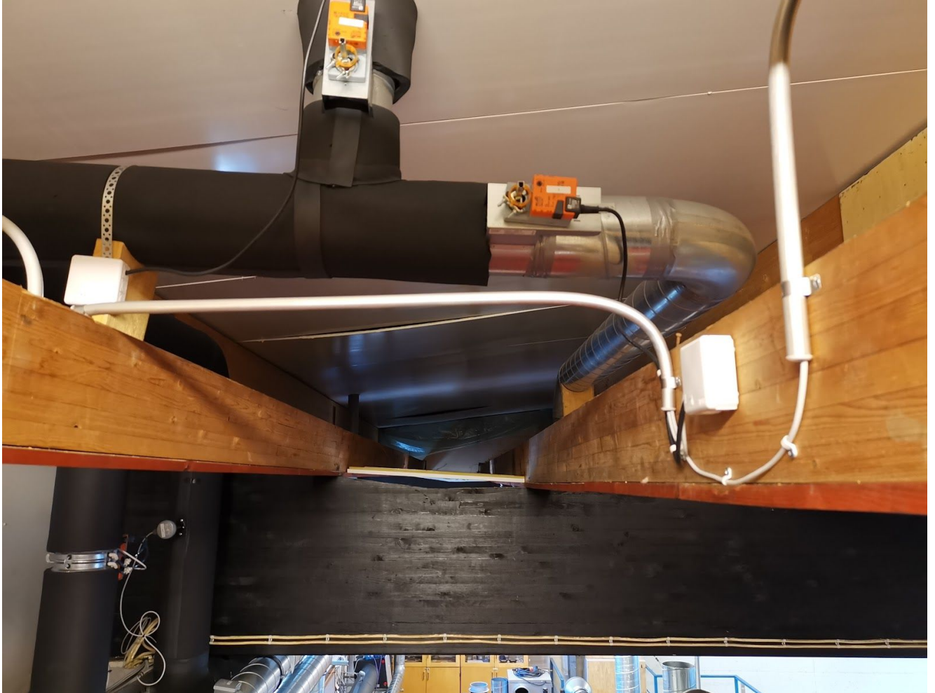
Figur 22. Avluftsroret ut genom taket, samt ventilspjäll samt kabelrör
