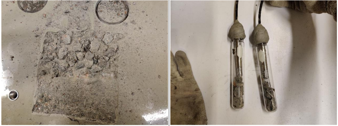
Kuva 10. Kuvassa vasemmalla on näytepalamenetelmän alueelta poistettu pinnoite ja pohjuste. Alueen yläosasta on piikattu betonimurusia, alaosassa on näkyvillä piikkaamatonta aluetta. Oikealla muruset on kerätty imuroituihin koeputkiin, joihin on asennettu suhteellisen kosteuden ja lämpötilan mittapäät. Mittapäiden kaapelit on tiivistetty koeputkien suuaukkoihin.
