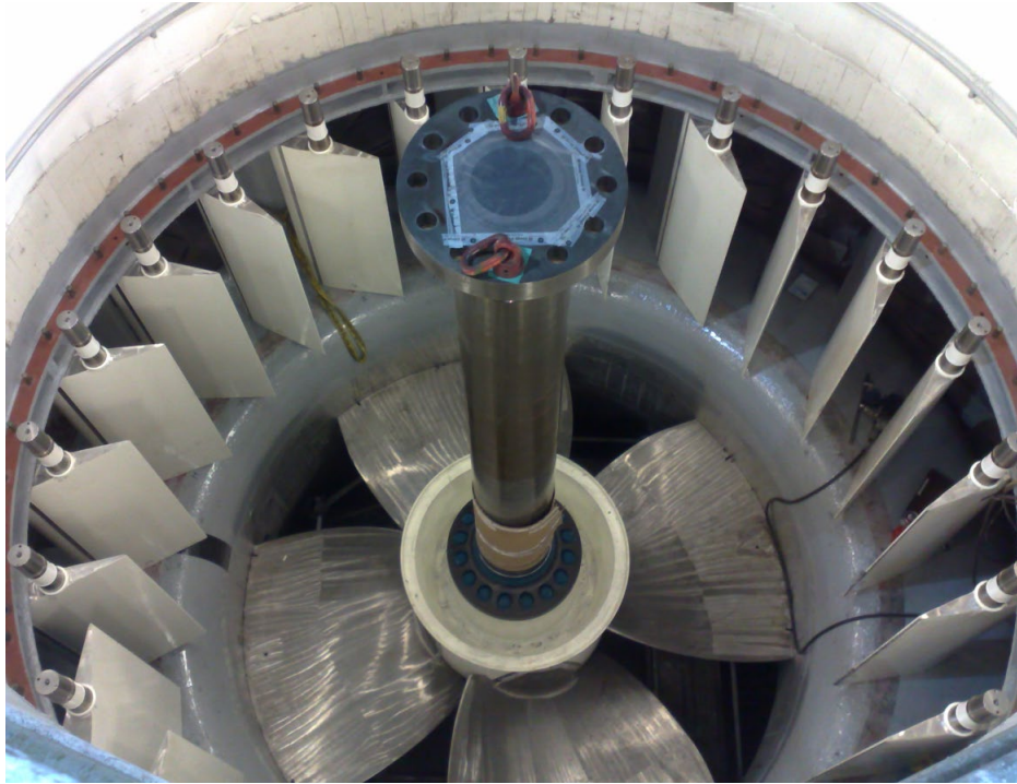
Kuva 3 Johtosiivet ja Kaplan-turbiini
