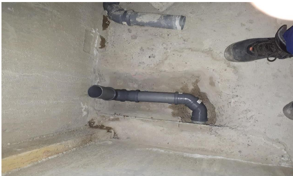
Kuva 11. Kuvassa uusi putken osa, joka asennuksen ja raudoitteen korjauksen jälkeen paikattiin betonilla. (Nurminen 2019)
