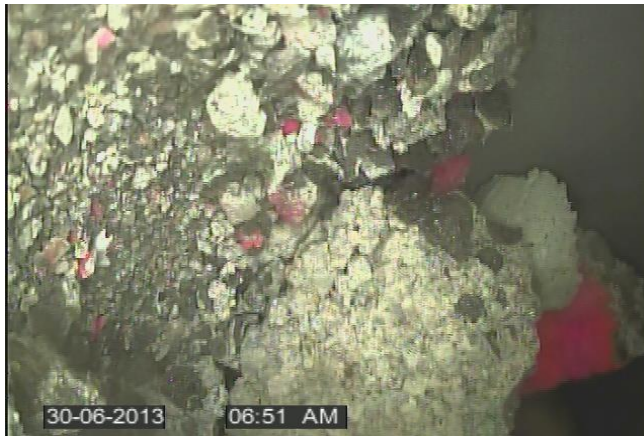
Kuva 10. Kuvassa tukkeutunut viemäri. (Nurminen 2019)
