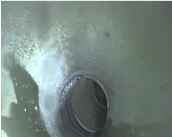
Kuva 7. Kuvassa kunnossa oleva viemäriin liitos. (Nurminen 2019)
