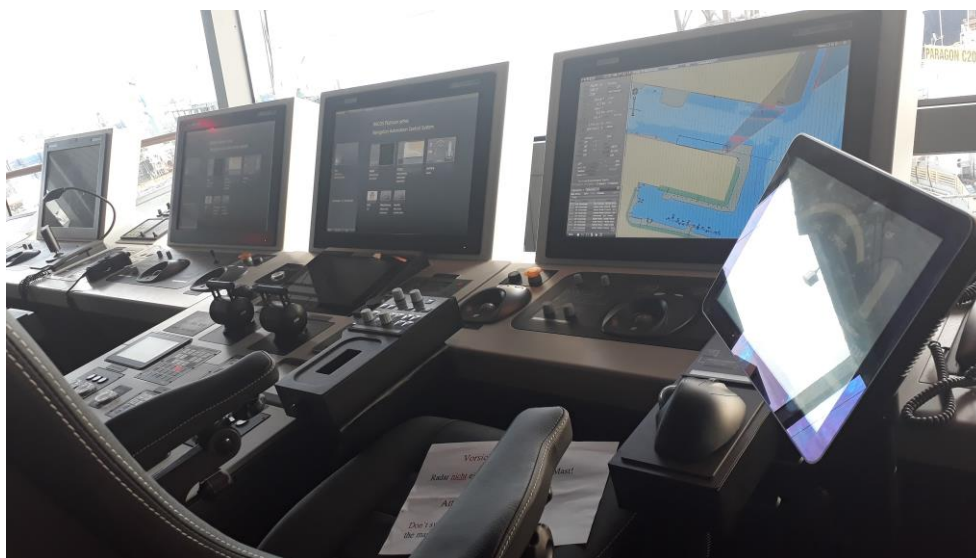
Kuva 20. Komentosillan 19 pääohjauspaikka (Wärtsilä 2020).
