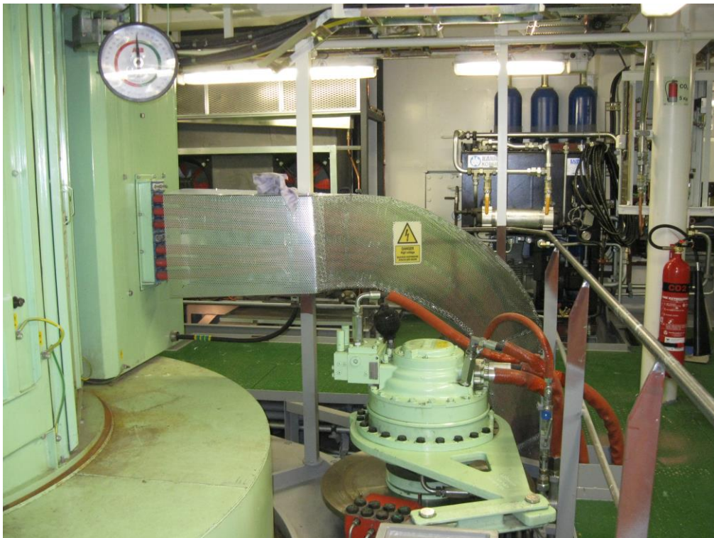
Kuva 19. Azipodin keskijännitekaapelit 3,3 kV, ja hydraulinen kääntökoneikon pumppu.
