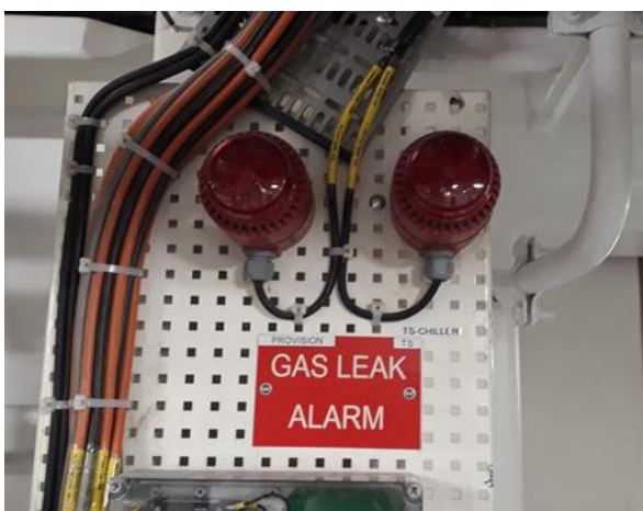
Kuva 32. Kaasuvuodon hälytin LNG-aluksessa.
