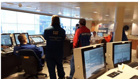
Kuva 22. Risteilyaluksen konevalvomo: Valmarinen voimalaitosautomaatio, MAK-Catepillar dieselmoottorit, ABB generaattorit.
