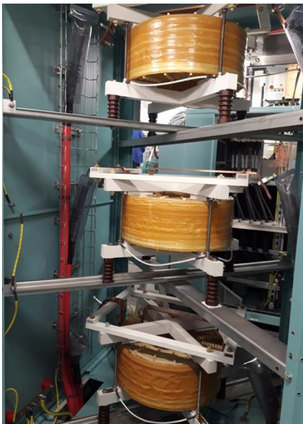
Kuva 15. RMU-suojaerotusmuuntaja 11kV:n sähköpäätaulussa (Schneider Electric 2020).
