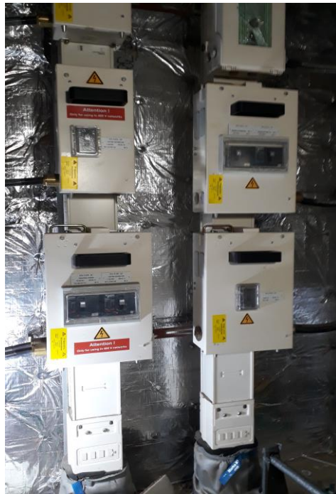
Kuva 24. Fire Zone Vertical Busbars 230V / 400V / 690V. Sähkönjakelua kannelta toiselle vertikaalisesti sekä paloalueelta toiselle horisontaalisesti.
