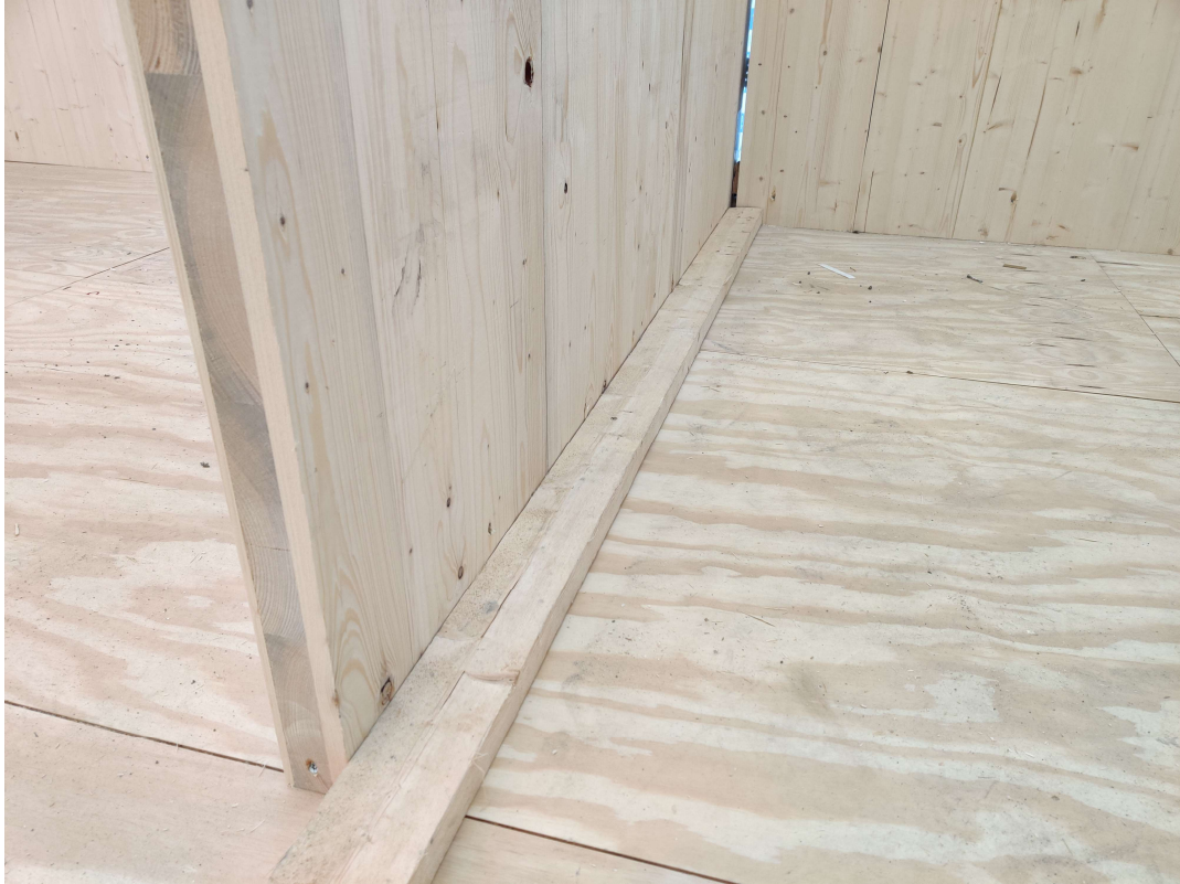
Kuva 30. Toisen kerroksen väliseinien ohjurilankku.
