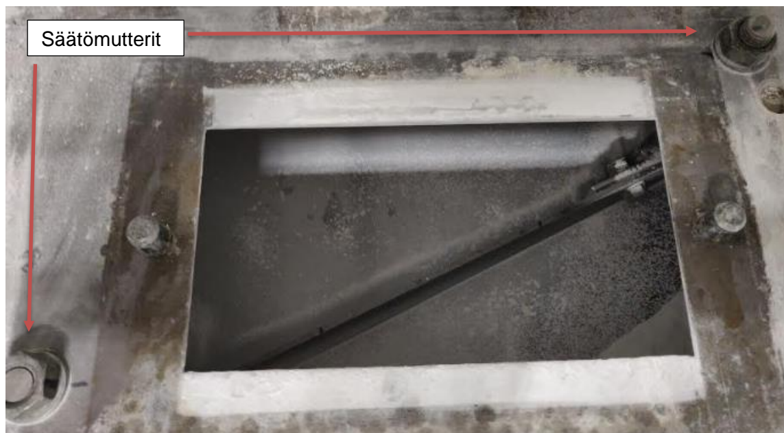
Kuva 14. Kuvassa säätömutterit 2a ja 2b sekä luukku, josta muttereita pääsee säätämään.
