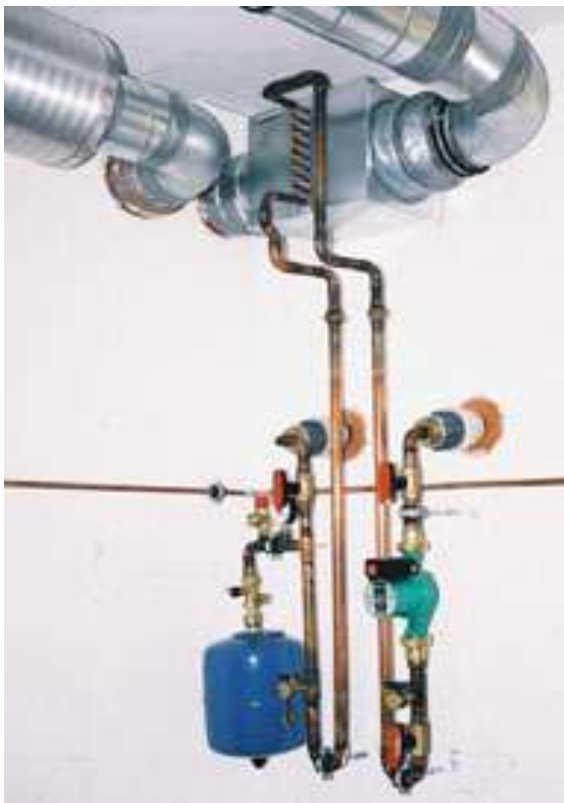
Bild 13. Här är en bild på hur det tekniska utrymmet på ett vätskeburet system kan se ut. (Brine based ground heat exchanger u.å.)
