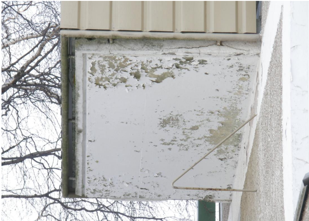
Kuva 4. Parvekelaatan alapinnan rapistunut maalipinta.
