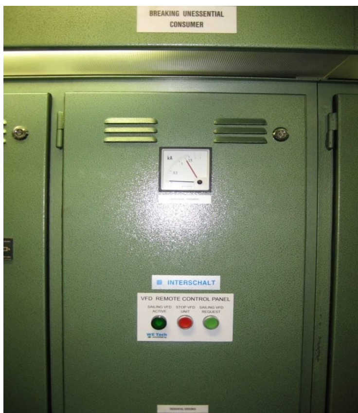
Figur 10. VFD kontrollpanel. (Eget arkiv, 2010d)
