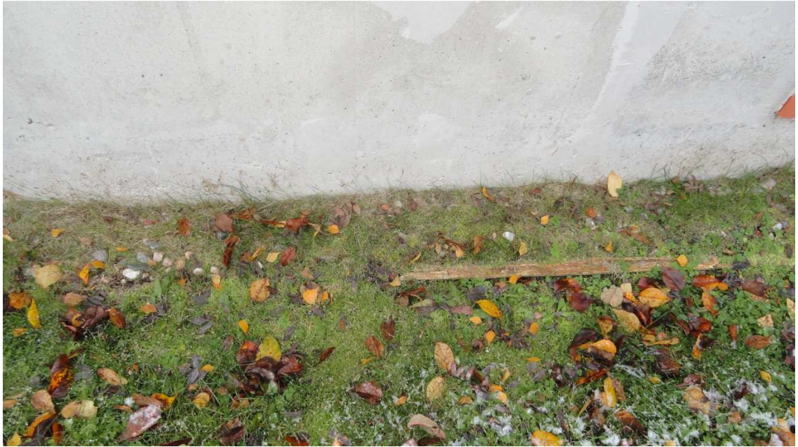
KUVA 2. Seinänvierustan sorakerroksen vedenläpäisy on heikentynyt oleellisesti (Halsitie 14)
