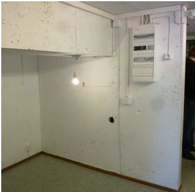
KUVA 5. Käyttösovellus 001: Valaistus, valmiiksi asennettuna /4/.
