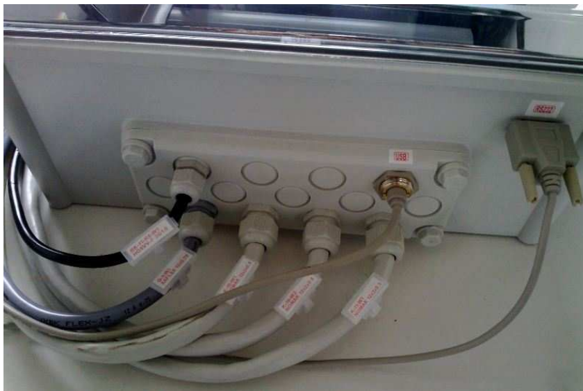
KUVA 32. Keskukselta lähtevä kaapelointi /4/.
