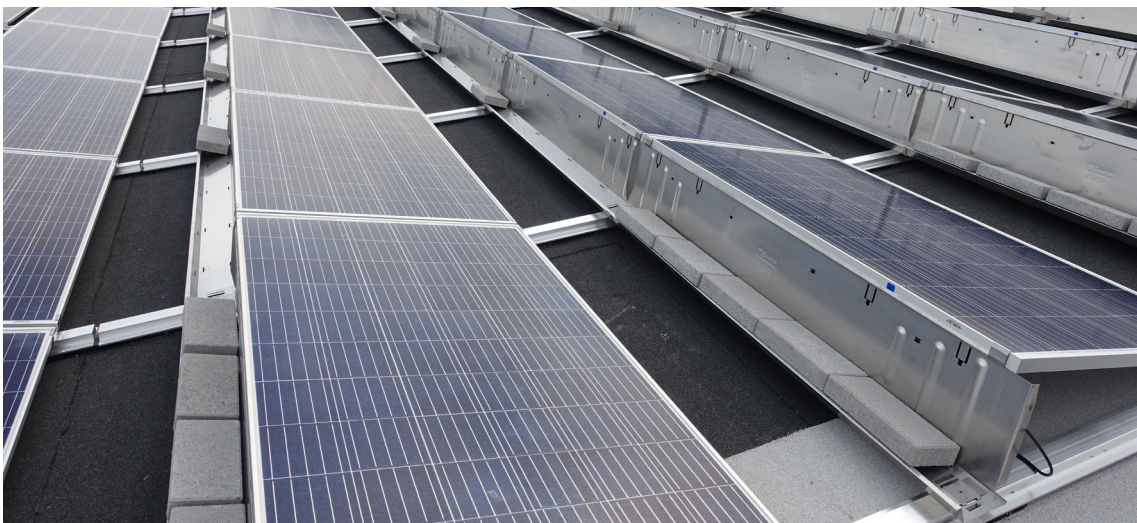
Kuva 3. Esimerkki asennuksesta SeaSide Industry Park Rauman aurinkovoimalasta. Kuva: Teemu Heikkinen.
